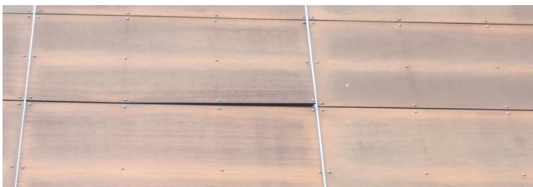
Figura 44 - Desprendimento de elementos de fixação
