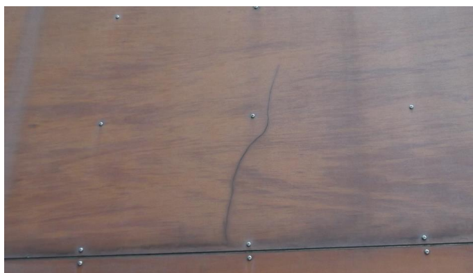
Figura 47 - Fissuração em painel fenólico
