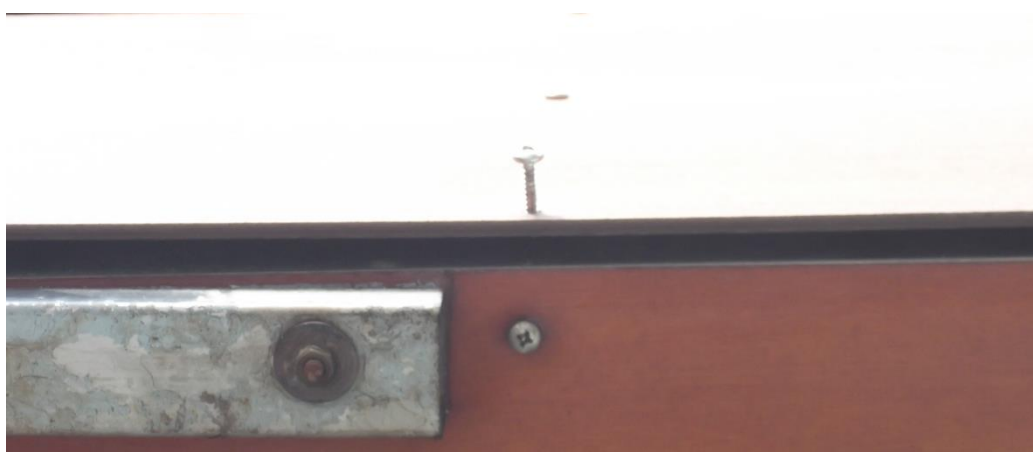
Figura 43 - Desprendimento de elementos de fixação
