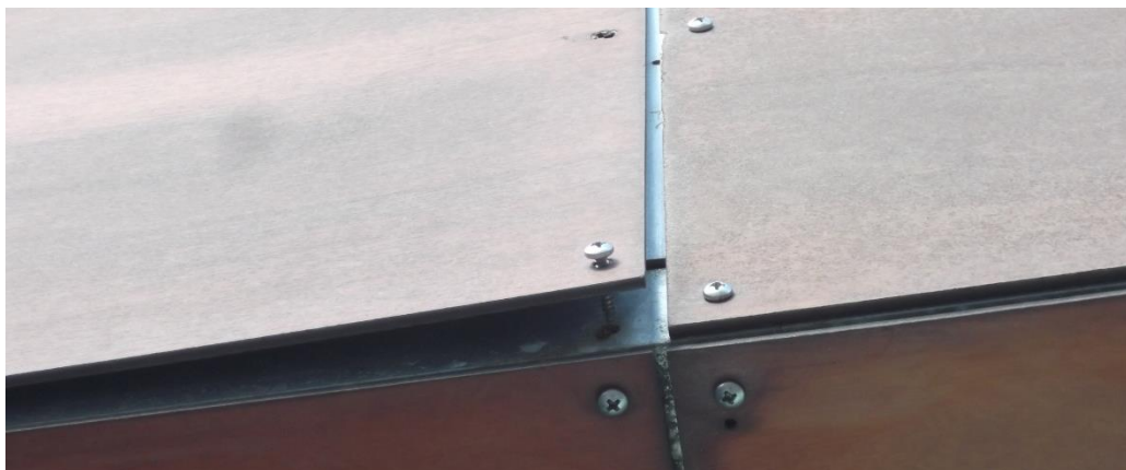
Figura 42 - Desprendimento dos elementos de fixação
