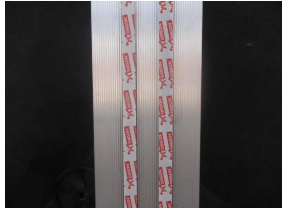
Figura 63 - Adesivo na zona de junta de dois painéis
