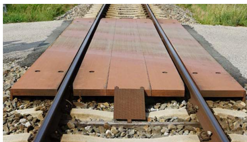
Figura 3.14 – Travessa FFU aplicada em passagem de nível (Sekisui, 2020a)
