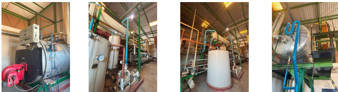
Figura 3.2 – Reservatórios utilizados no processo de creosotagem
