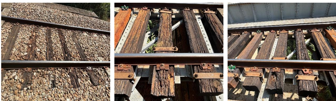
Figura 4.55 – Ponte da Várzea, Travessas degradadas
