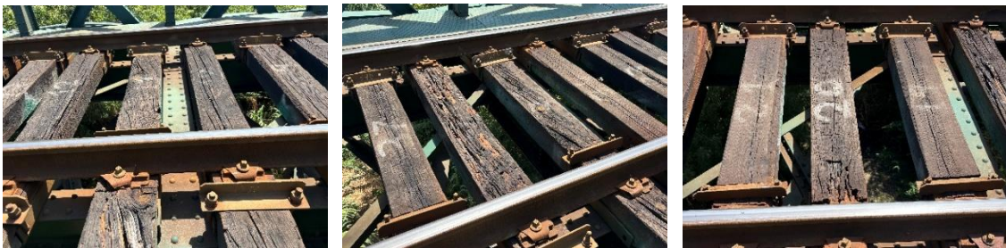
Figura 4.7 – Ponte de Alferrarede, Travessas degradadas
