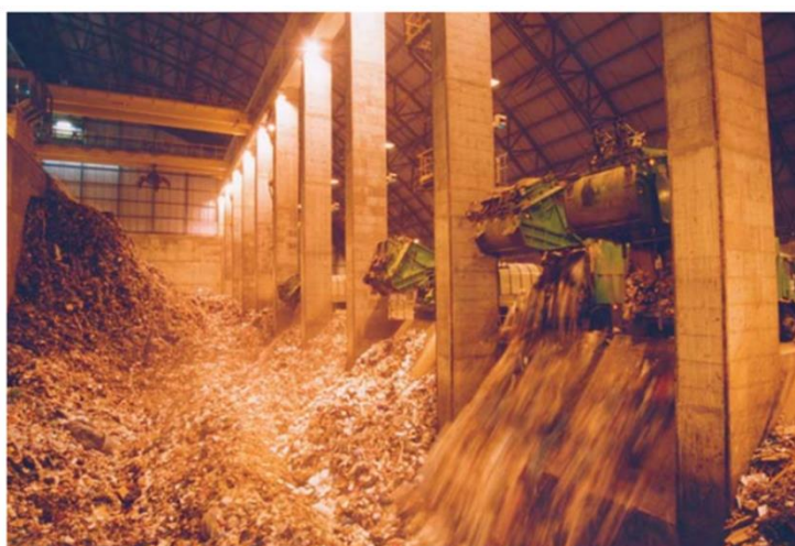
Figura 2.16 - Fossa de armazenamento de RSU [27]
