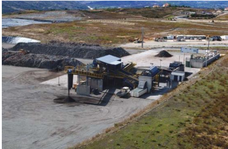
Figura 2.9- Instalação de Tratamento e Valorização de Escórias [27]
