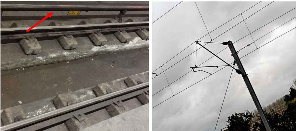
Figura 2.3 - Terceiro carril do metro de Lisboa (esquerda) e catenária dos comboios de Portugal (direita)
