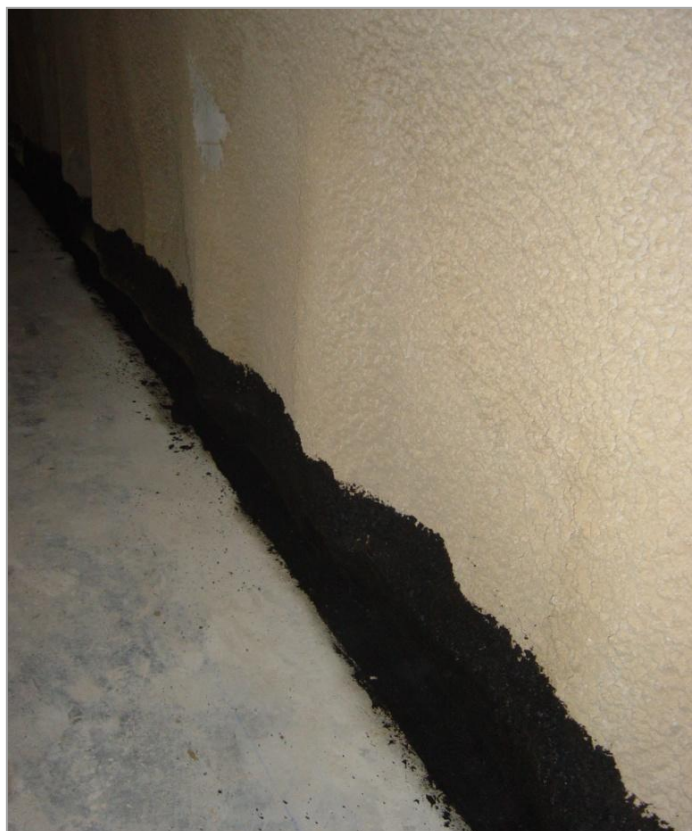
Figura 13. Zona da caleira após aplicação de duas demãos de emulsão betuminosa no piso -2.
