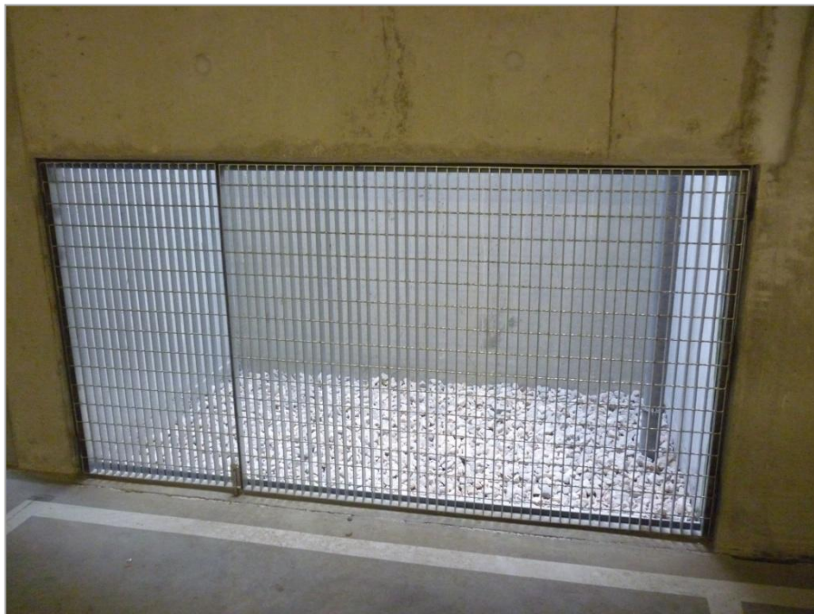
Figura 60. Tubo de queda no fosso de ventilação, proveniente do piso -1, que conduz as águas para a camada intermédia de brita.
