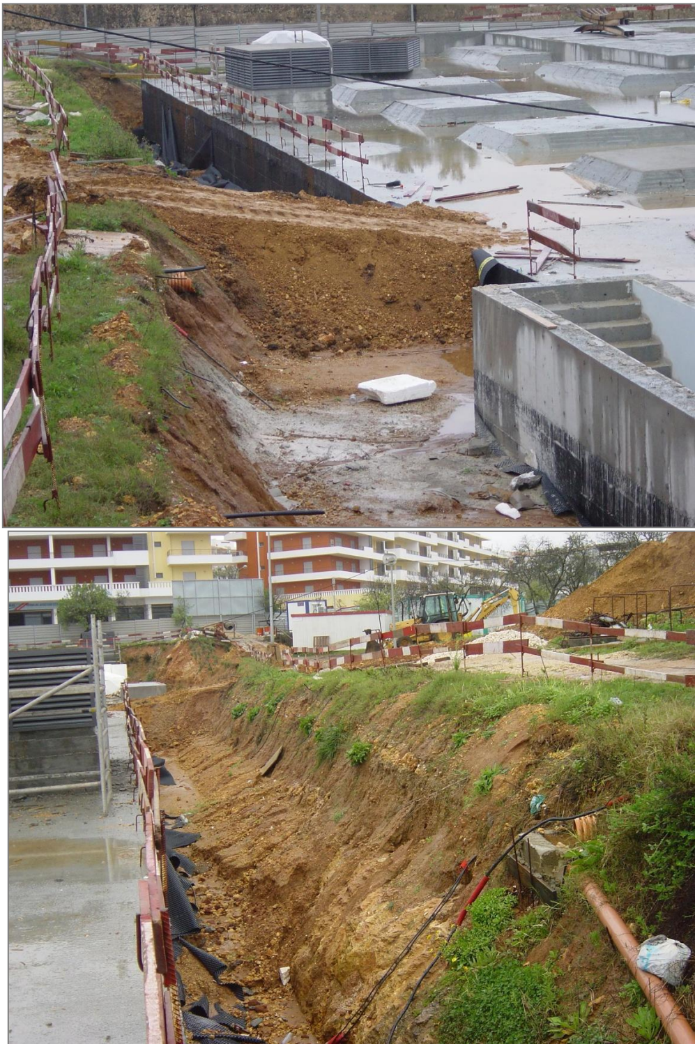
Figura 22. Queda dos painéis “Aquadrain” após mau tempo.
