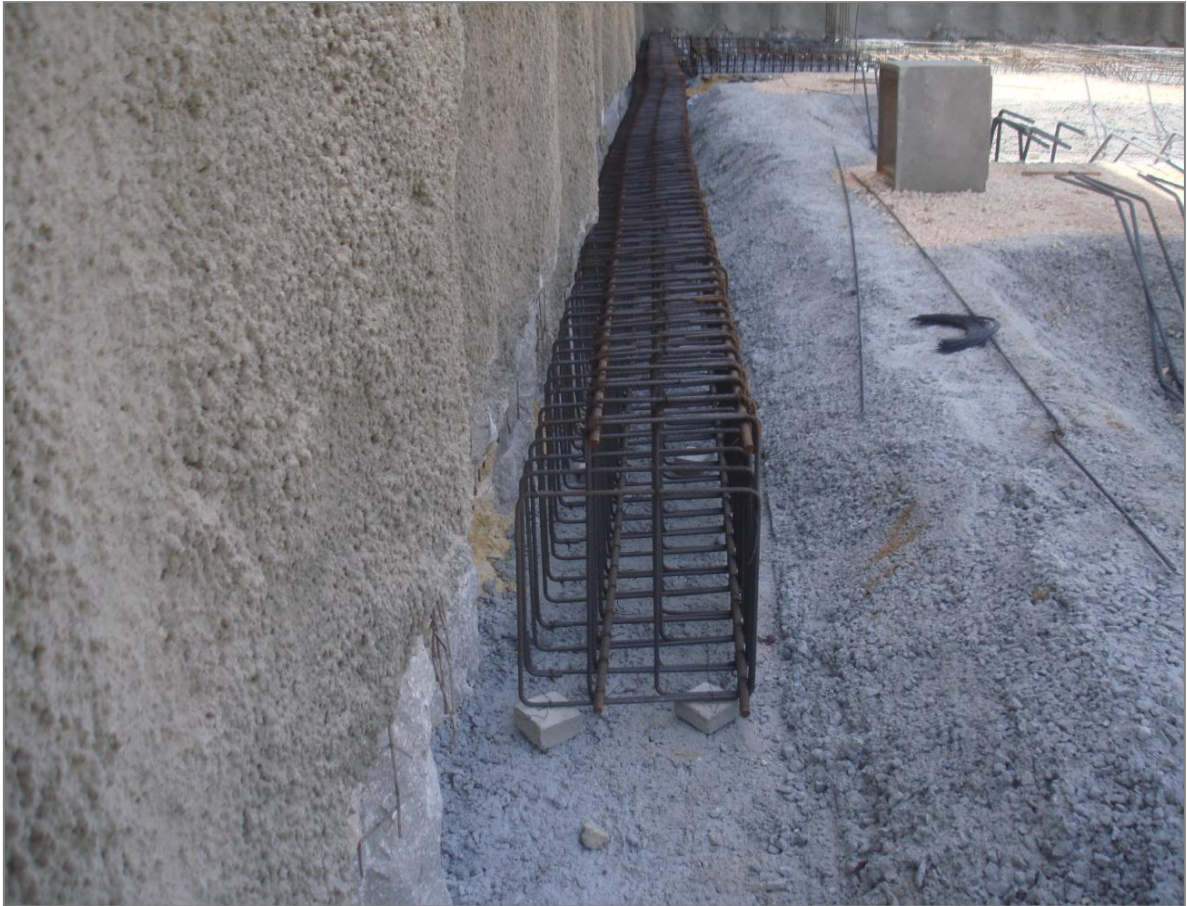
Figura 12. Aplicação em obra da viga “recortada” para a introdução da caleira no piso -2.
