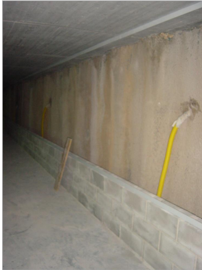
Figura 16. Zona da caleira após execução de alvenaria em blocos de betão com 60 cm de altura no piso -2.
