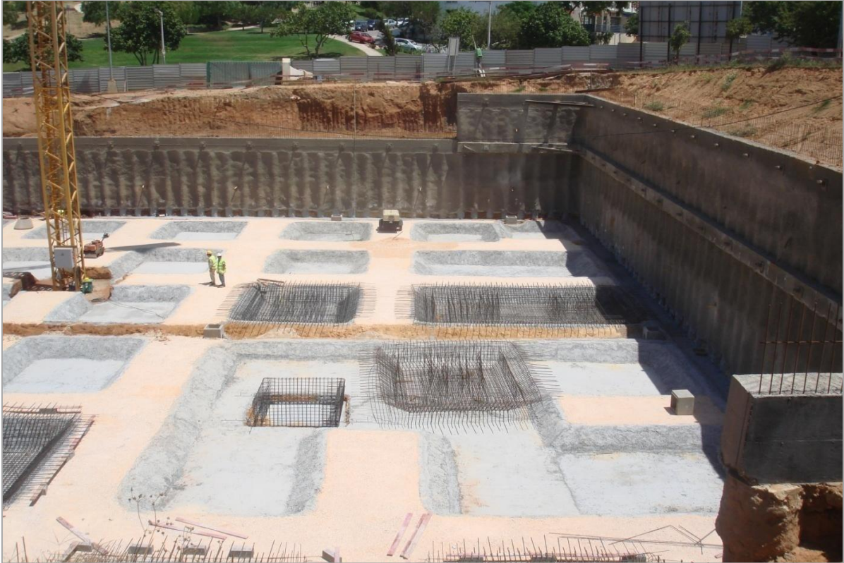
Figura 5. Vista de cortina de estacas com o primeiro e segundo níveis de ancoragens.
