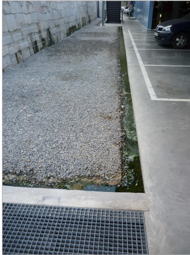
Figura 59. Caleira para recolha de águas na zona das caixas de escadas do piso -1.
