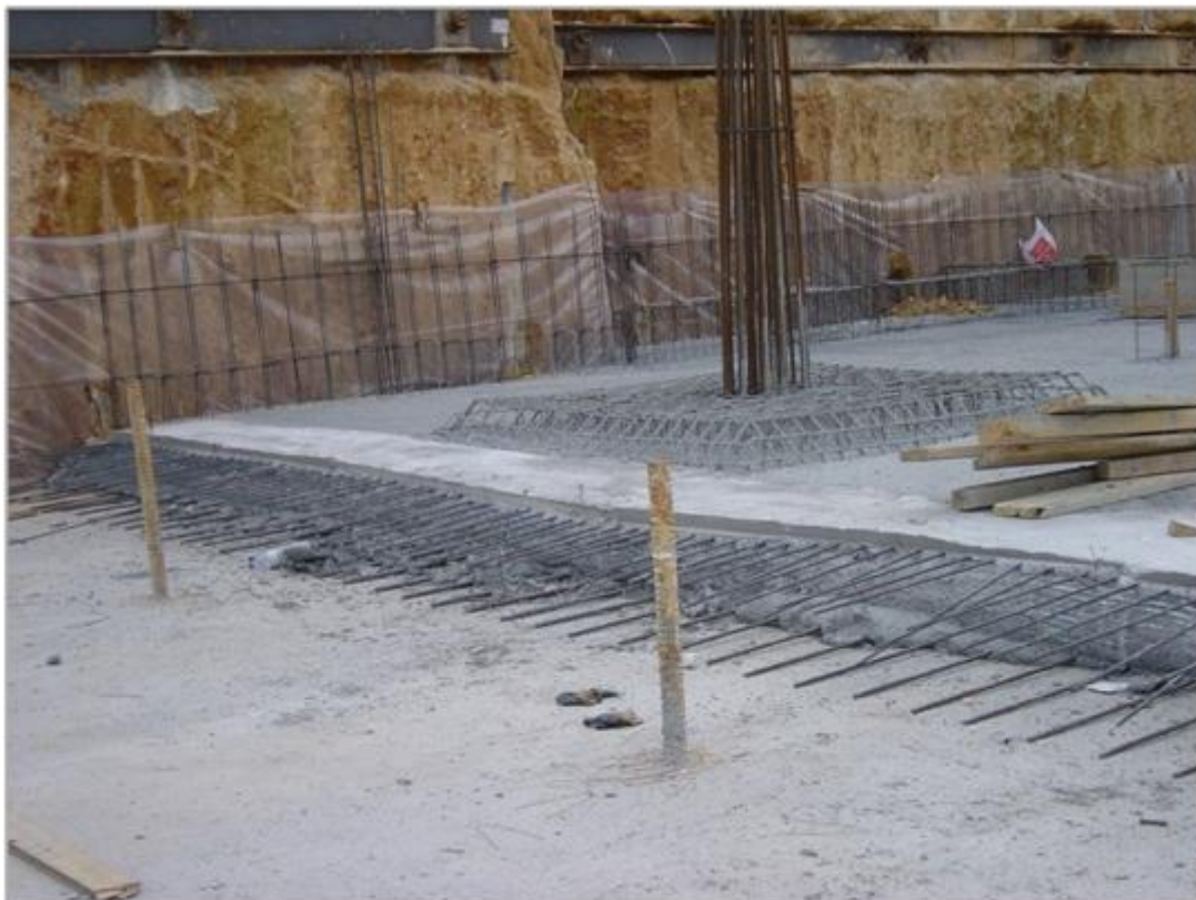
Figura 53. Camadas de PVC, betão de limpeza e laje em betão armado (sem qualquer dispositivo Waterstop).
