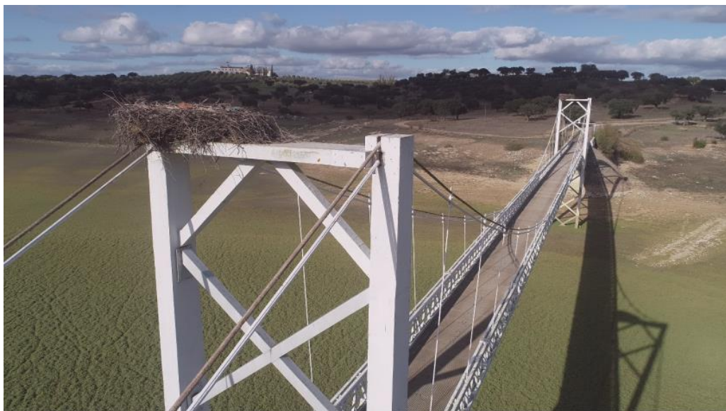
Figura 3-28 Presença dos ninhos de cegonha nas extremidades superiores de ambos os pilares (Edgar Cardoso - Engenharia e Laboratório de Estruturas, 2020).
