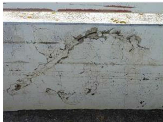
Figura 3-23 Zonas de betão com fissuração e fenómenos de delaminação e descasque de betão, com exposição de armadura (Edgar Cardoso - Engenharia e Laboratório de Estruturas, 2020).
