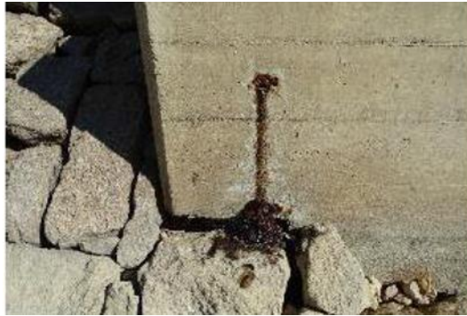
Figura 3-20 Escorrência da massa protetora (Edgar Cardoso - Engenharia e Laboratório de Estruturas, 2020).
