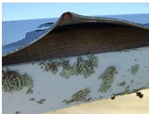
Figura 3-37 Danos na proteção antivandalismo dos cabos principais (Edgar Cardoso - Engenharia e Laboratório de Estruturas, 2020).
