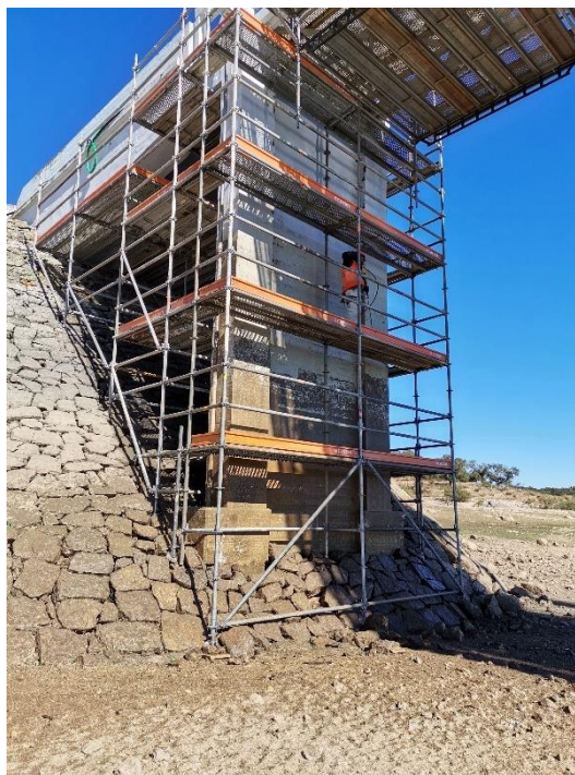
Figura 5-12 Lavagem do encontro nomeadamente uma zona submersa.
