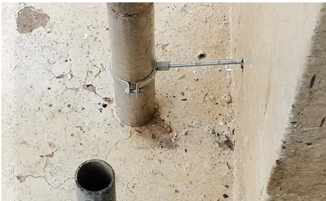
Figura 5-59 Braçadeira substituída de tirante.
