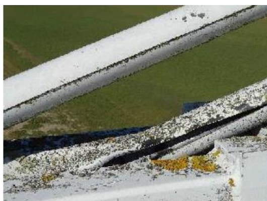
Figura 5-52 Bainha em meia cana de proteção dos cabos principais danificada.
