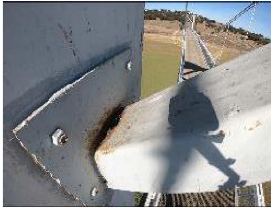
Figura 3-26 Presença de corrosão no contraventamento (Edgar Cardoso - Engenharia e Laboratório de Estruturas, 2020).
