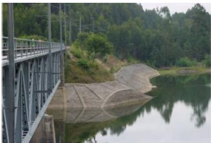
Figura 2-29 Taludes não vegetal. (Lopes, 2016)
