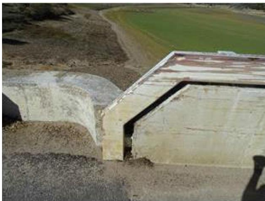
Figura 3-22 Danos na pintura dos perfis metálicos (Edgar Cardoso - Engenharia e Laboratório de Estruturas, 2020).
