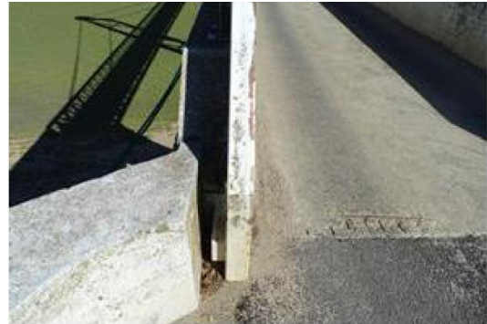
Figura 3-21 Armadura exposta (Edgar Cardoso - Engenharia e Laboratório de Estruturas, 2020).
