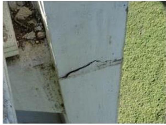
Figura 3-27 Destacamento de betão na zona da rótula (Edgar Cardoso - Engenharia e Laboratório de Estruturas, 2020).
