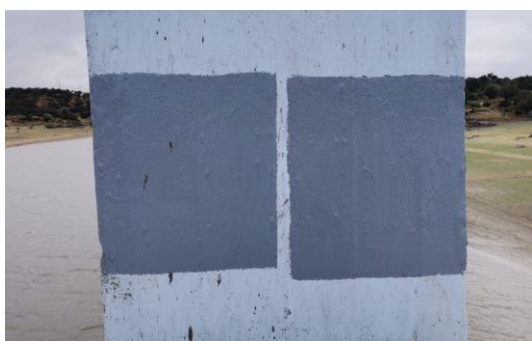
Figura 5-22 Testes de tinta em superfícies de betão.
