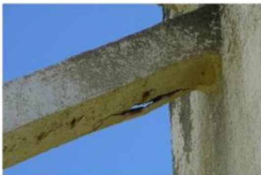
Figura 3-24 Zona de delaminação dos contraventamentos, expondo a armadura (Edgar Cardoso - Engenharia e Laboratório de Estruturas, 2020).
