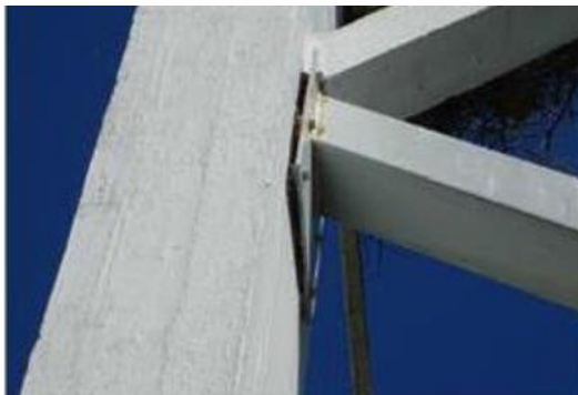
Figura 3-25 Deficiente ligação entre contraventamento e pilar (Edgar Cardoso - Engenharia e Laboratório de Estruturas, 2020).
