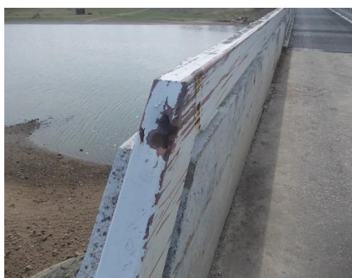
Figura 5-50 Elementos metálicos danificados, resultado de colisões de veículos.
