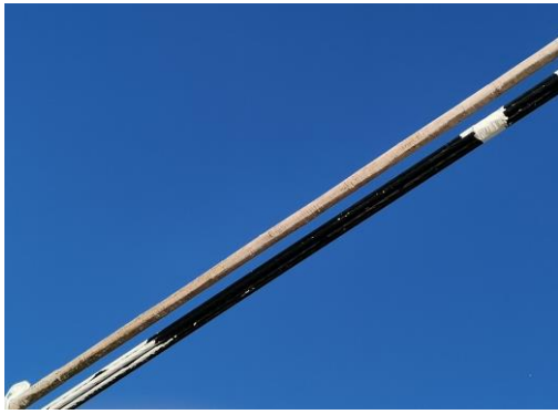
Figura 5-55 Estado dos cabos após a lavagem.
