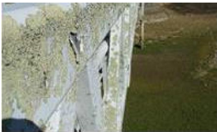
Figura 3-31 Colonização biológica existente e alguma escamação da camada de tinta (Edgar Cardoso - Engenharia e Laboratório de Estruturas , 2020).
