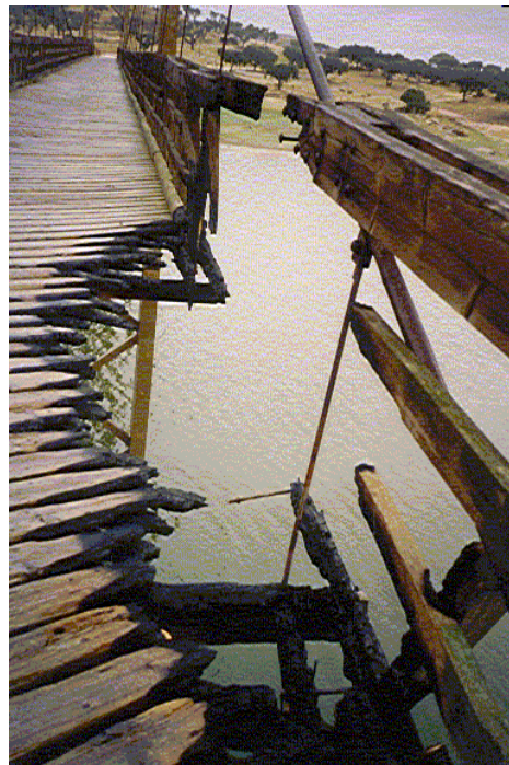
Figura 3-2 Ponte de Ervedal com tabuleiro em madeira parcialmente queimado.(Ferraz et al., 2002)
