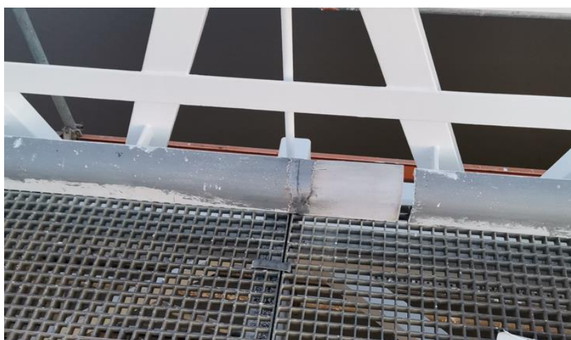
Figura 5-49- Extremidade de guarda rodas substituída.
