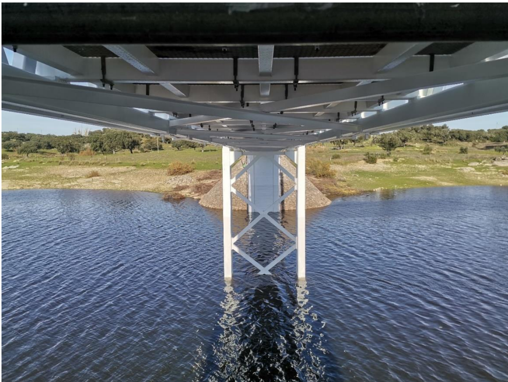
Figura 5-25 Superfícies de betão concluídas no lado de Figueira e Barros, sob o tabuleiro.
