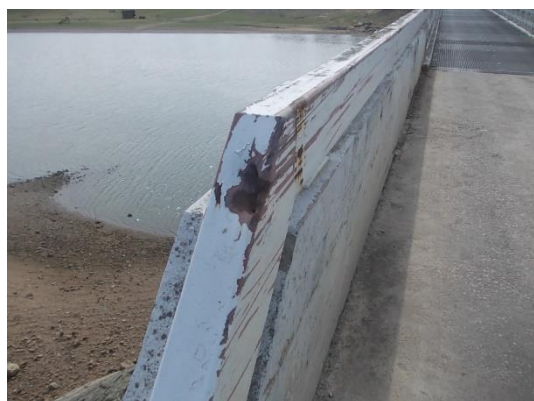
Figura 3-32 Elementos metálicos danificados, resultado de colisões de veículos (Edgar Cardoso - Engenharia e Laboratório de Estruturas, 2020).
