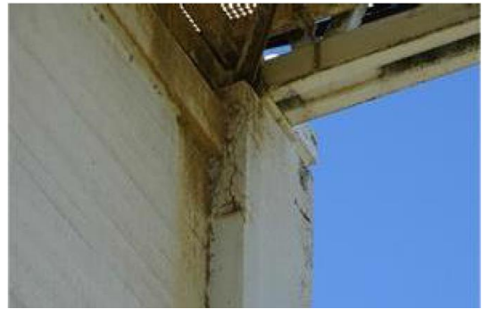
Figura 3-19 Fissuração na Zona de Apoios (Edgar Cardoso - Engenharia e Laboratório de Estruturas, 2020).
