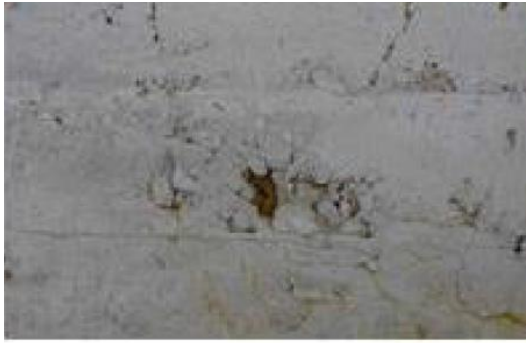
Figura 3-18 Patologia de betão originada por uma execução pouco cuidada (Edgar Cardoso - Engenharia e Laboratório de Estruturas, 2020).
