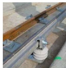
Figura 3-87 – Pormenor de Isolador [43]
