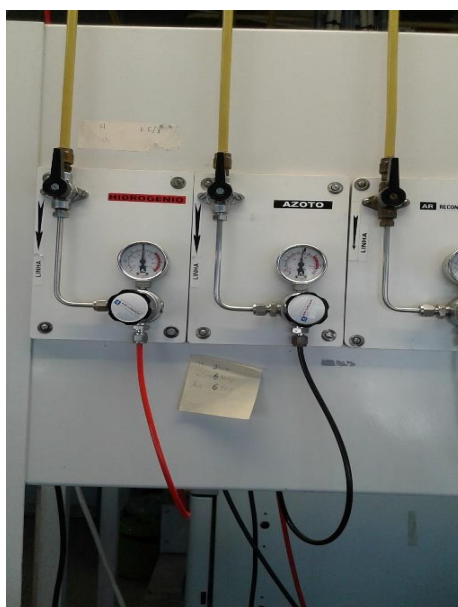
Figura 97 - Manorredutores da unidade.
