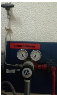
Figura 109 - Imagem de controlo da pressão de gás à entrada da unidade.
