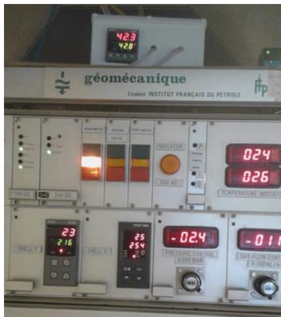
Figura 107 - Painel de controlo da unidade.
