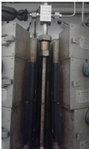
Figura 104 - Imagem do reator inserido na unidade revestido com a camisa de aquecimento.
