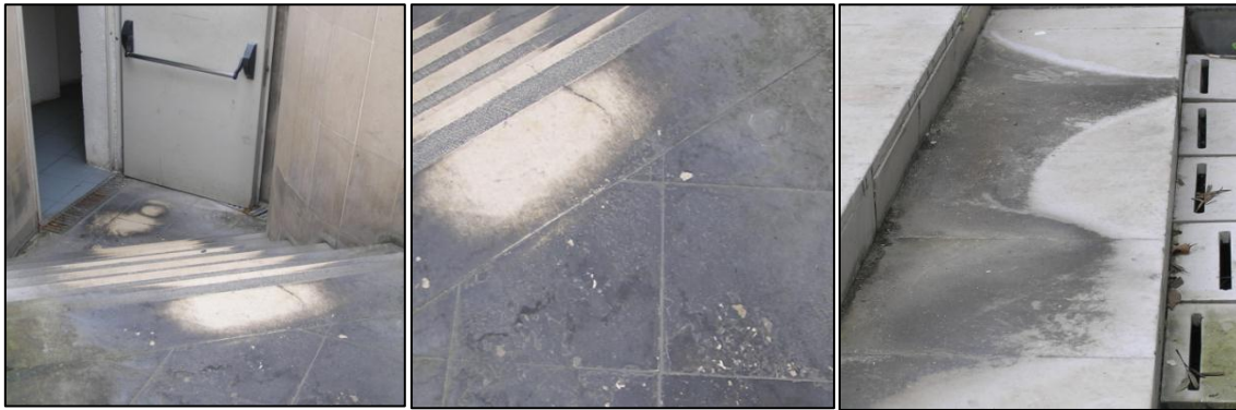
Fig. 17 – Incrustações e manchas - escada em vidro de Moleanos
