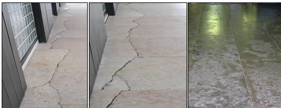
Fig. 30 – Assentamento diferencial de fundação com repercussões no revestimento
