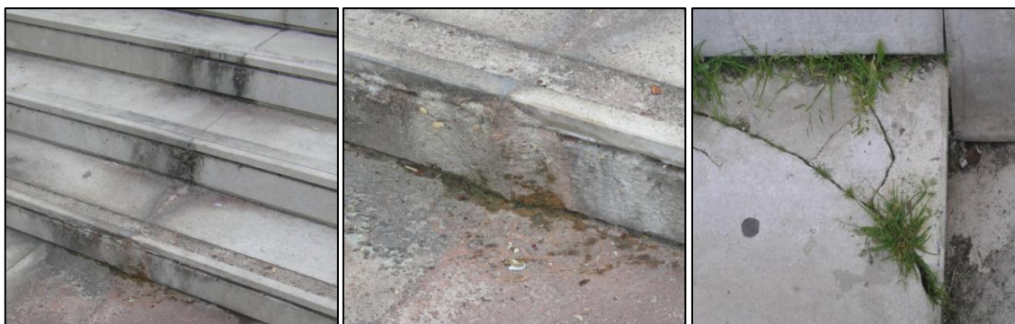
Fig. 38 – Escada exterior em vidraço de Moleanos - eflorescências e vegetação
