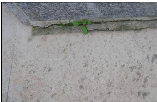
Fig. 35 – Junta vertical exposta, tendo originado o aparecimento de vegetação
