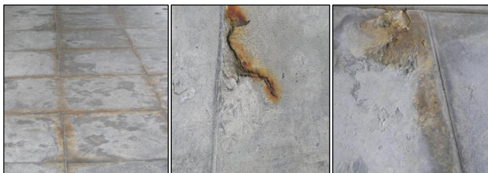
Fig. 28 – Mancha e criptoflorescências – pavimento em azul Valverde amaciado
