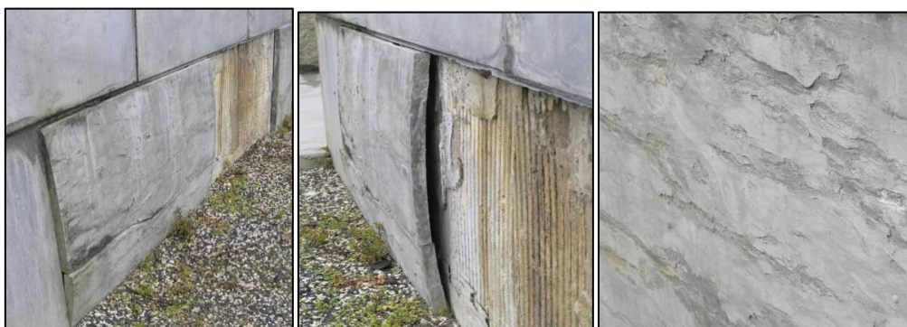
Fig. 26 – Eflorescência, deformação e lascagem - paramento vertical em azul Valverde
