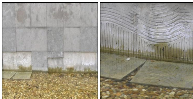
Fig. 42 – Embasamento em pedra azul Valverde submerso em lago artificial
