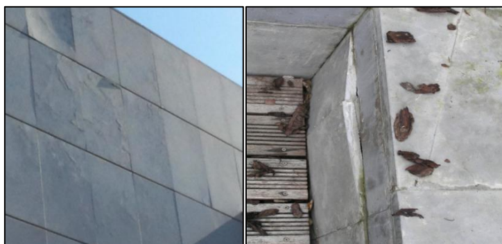
Fig. 39 – Patologia em elementos verticais por ausência de juntas deformáveis
