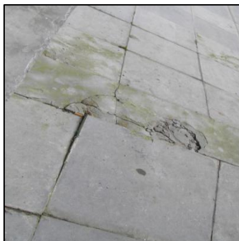
Fig. 40 – Patologia em pavimento por ausência de juntas deformáveis
