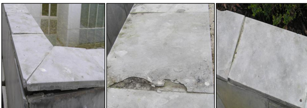
Fig. 22 – Junta aberta, deformação e lascagem – capeamento em azul Valverde
