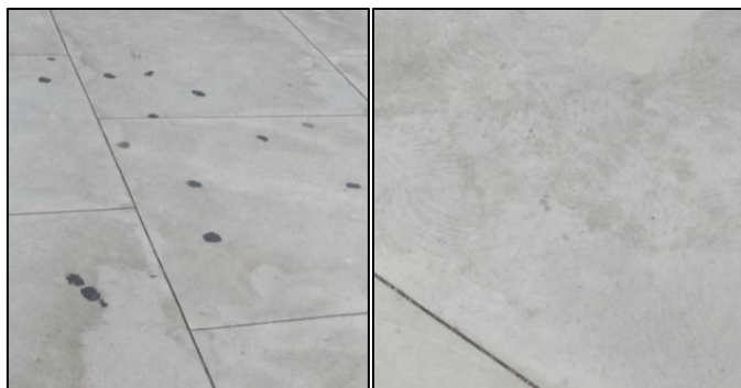
Fig. 59 – Tentativa de limpeza com uso indevido de abrasivos
