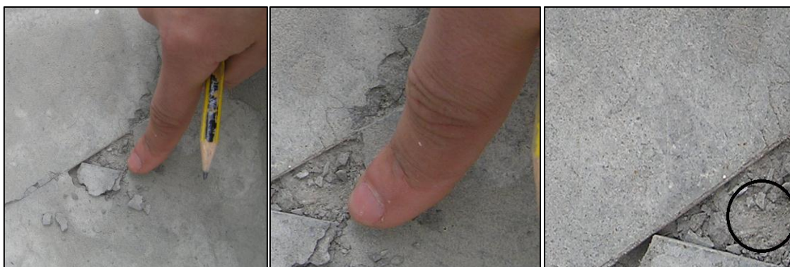
Fig. 23 – Desagregação granular – pavimento em azul Valverde
