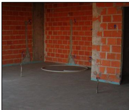
Fig. 34 – Dessolidarização entre o piso e elementos verticais
