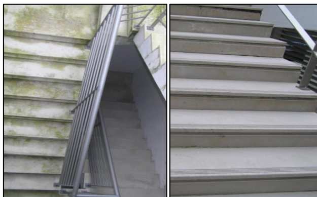
Fig. 48 – Degraus de escada exterior em vidraço de Moleanos e vidraço de Ataija creme
