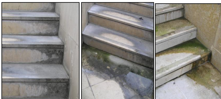
Fig. 58 – Deficiente execução de pendente e parca manutenção
