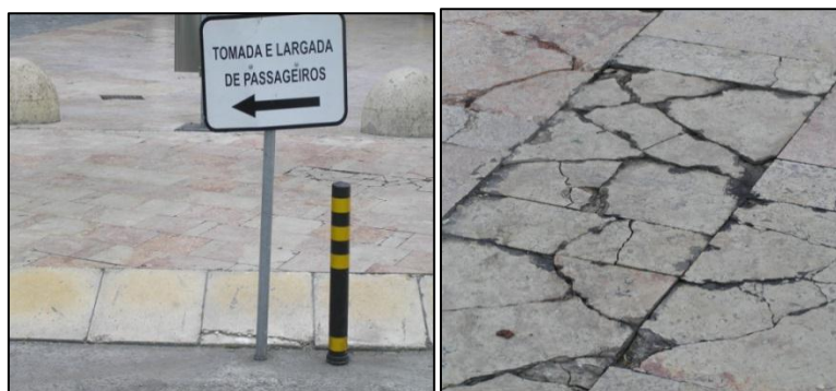
Fig. 45 – Ineficaz dimensionamento de laje de pavimento exterior em Lioz (veículos)
