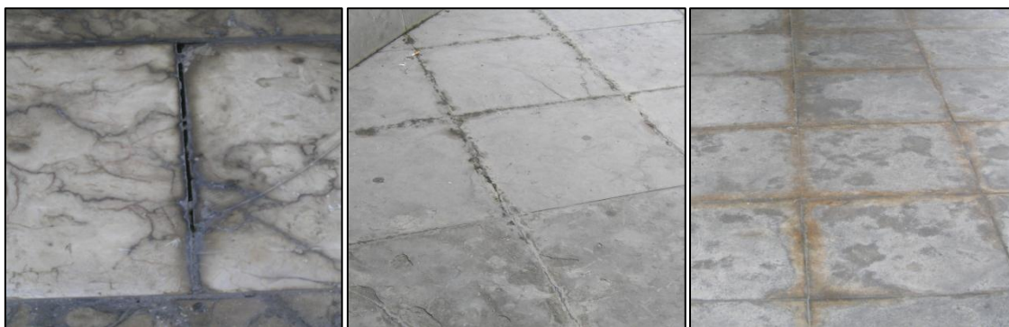
Fig. 37 – Pavimento exterior em Lioz e azul Valverde - junta aberta e alteração de cor
