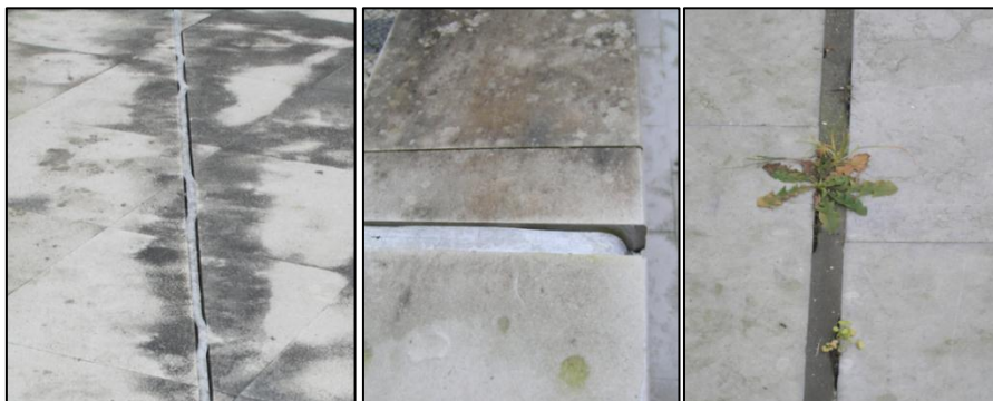
Fig. 52 – Patologia em superfícies calcárias horizontais associadas a juntas de dilatação
