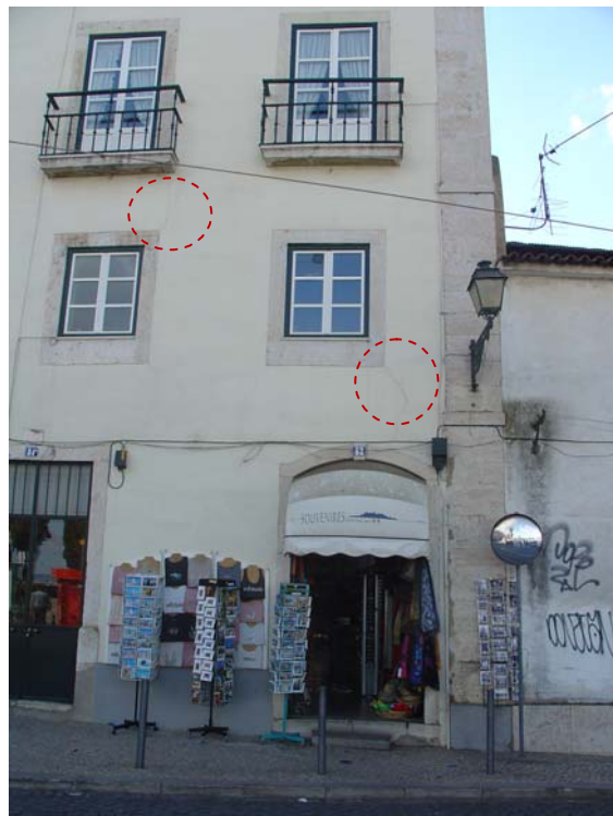
Figura 33 – Fendilhação de rebocos nas zonas de apoio do lintel (F-C1) e a partir das esquinas inferiores da abertura (F-C2) devido à concentração excessiva de esforço
