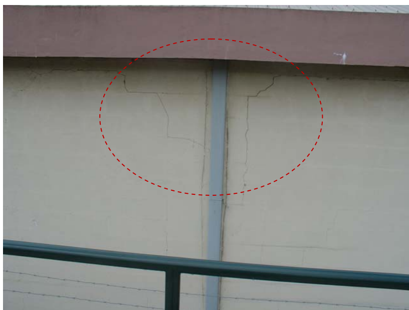
Figura 20 – Ilustração da fendilhação vertical, contínua (F-B3), devida à dilatação térmica diferencial do tijolo e da argamassa. Tijolos com fraca resistência à tracção
