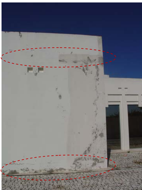
Figura 27 – Fendilhação horizontal (F-A3), na ligação da platibanda à laje de cobertura e na ligação da parede à laje de piso, devido à expansão térmica dos materiais da própria parede, em panos de pequena dimensão
