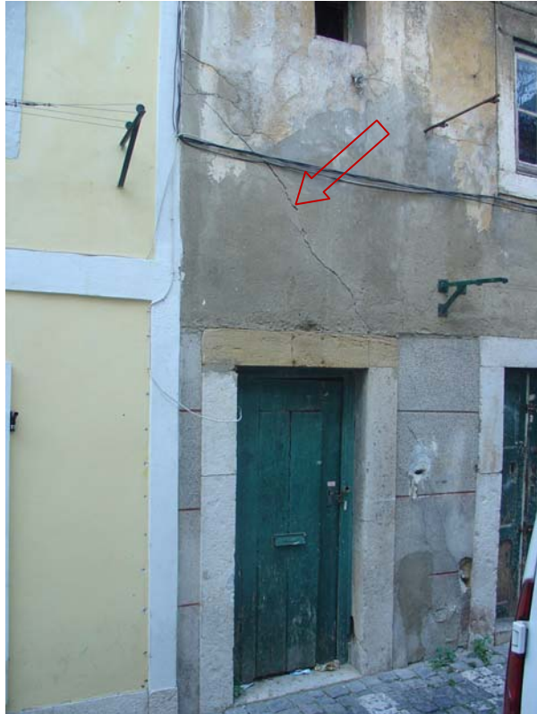
Figura 43 – Tipologia de fendilhação (F-C7) de rebocos devida a assentamentos diferenciais em fundações directas assentes sobre zonas de aterro e de escavação
