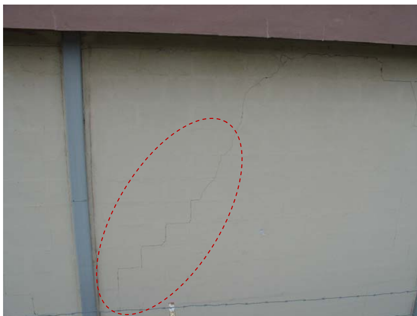
Figura 18 – Fendilhação contínua, em degraus, pelas juntas de argamassa (F-C1) devida à dilatação térmica diferencial do tijolo e da argamassa. Argamassa com fraca resistência à tracção
