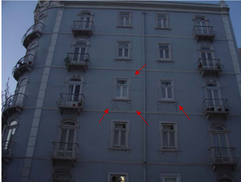
Figura 32 – Tipologia de fendilhação de rebocos nas zonas de apoio do lintel (F-C1) e a partir das esquinas inferiores da abertura (F-C2) devido à concentração excessiva de esforço [12]
