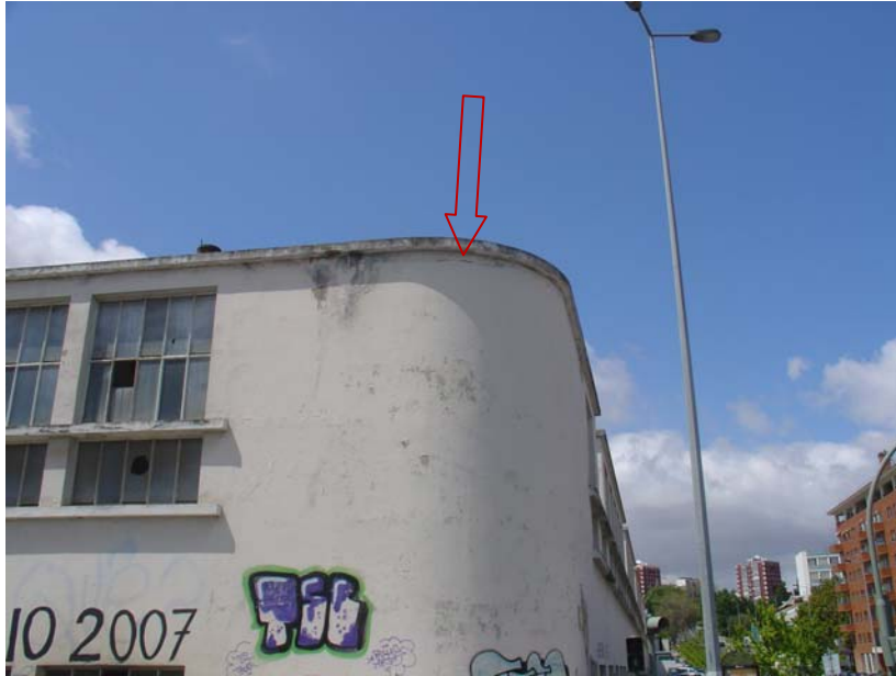
Figura 14 – Fendilhação de paredes sem carga vertical significativa, devida aos movimentos térmicos das coberturas planas
