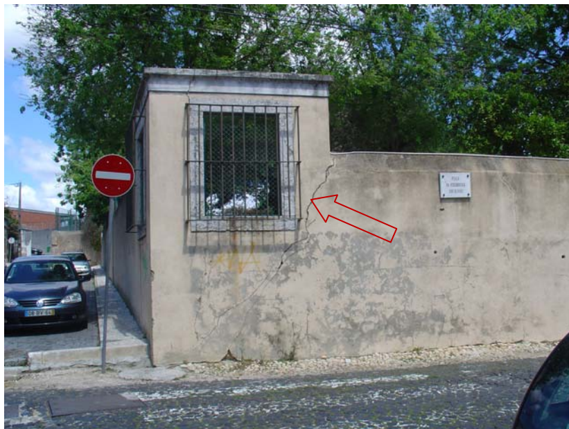
Figura 44 – Ilustração da fendilhação de rebocos (F-C7) devida a assentamentos diferenciais em fundações directas assentes sobre zonas de aterro e de escavação
