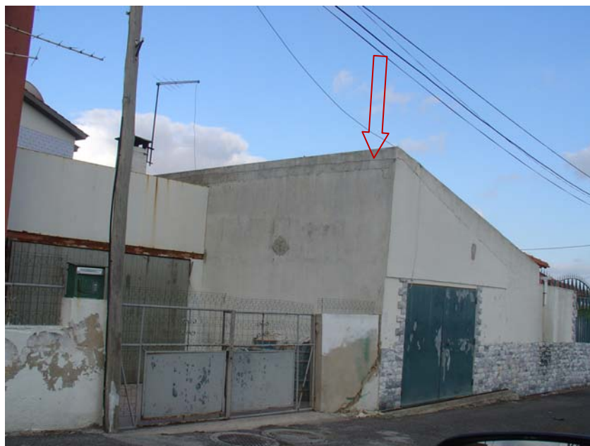
Figura 13 – Fendilhação horizontal no perímetro da cobertura (F-A3). Desenvolvimento dos deslocamentos de origem térmica, numa laje de cobertura com os bordos vinculados às paredes de sustentação
