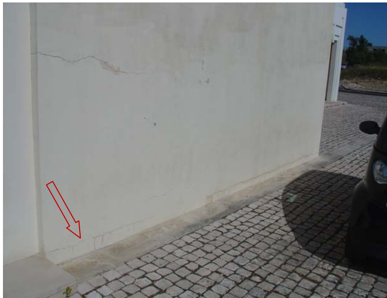
Figura 10 – Ilustração de fendilhação de rebocos, associada a variações do teor de humidade dos materiais, devida à transferência de humidade do solo para a parede
