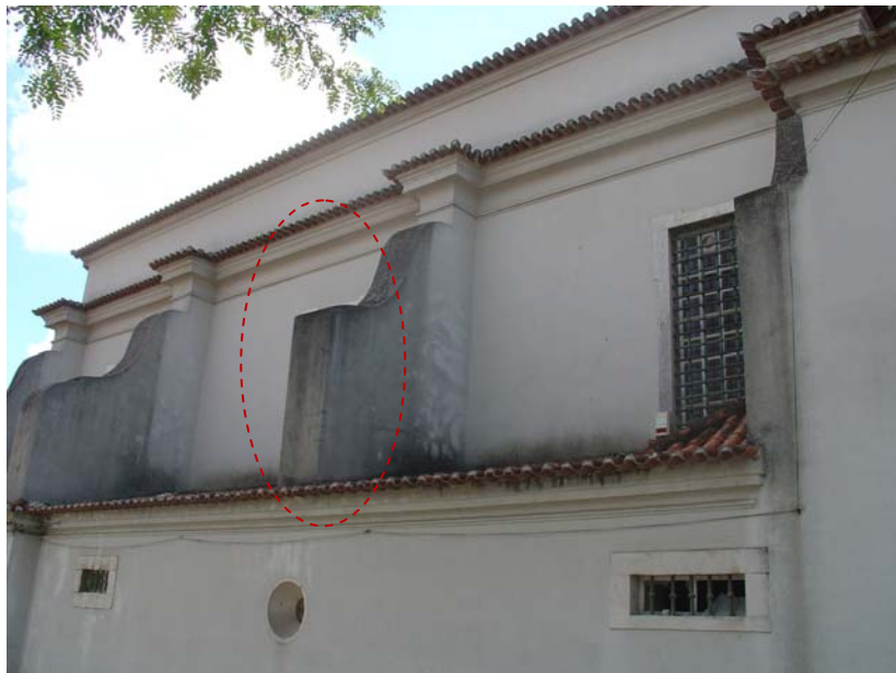
Figura 48 – Fendilhação de rebocos com elevado teor em ligante (F-D2)
