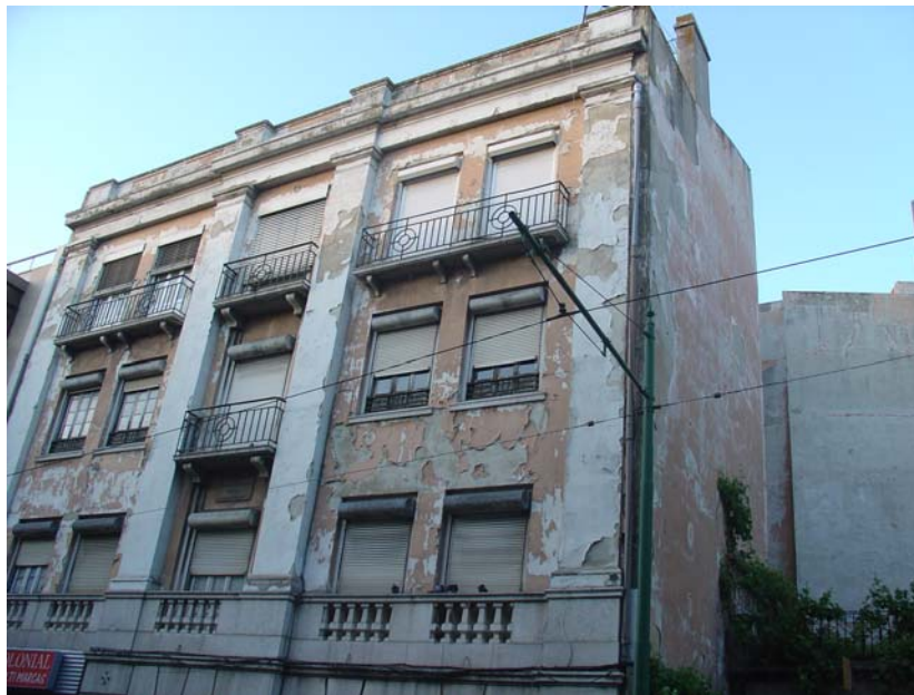
Figura 2 - Destacamento do reboco
