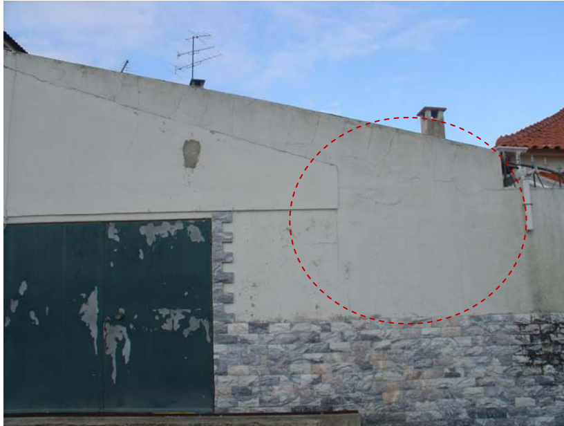
Figura 49 – Fendilhação de rebocos devido à retracção restringida do reboco (F-D1)
