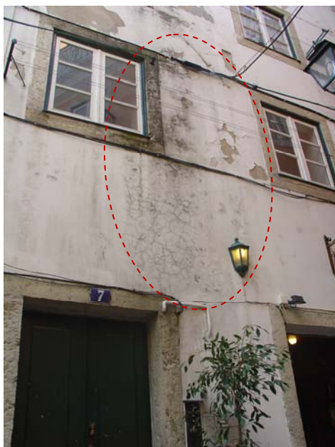
Figura 52 – Fendilhação de rebocos devido à retracção restringida do reboco (F-D1)
