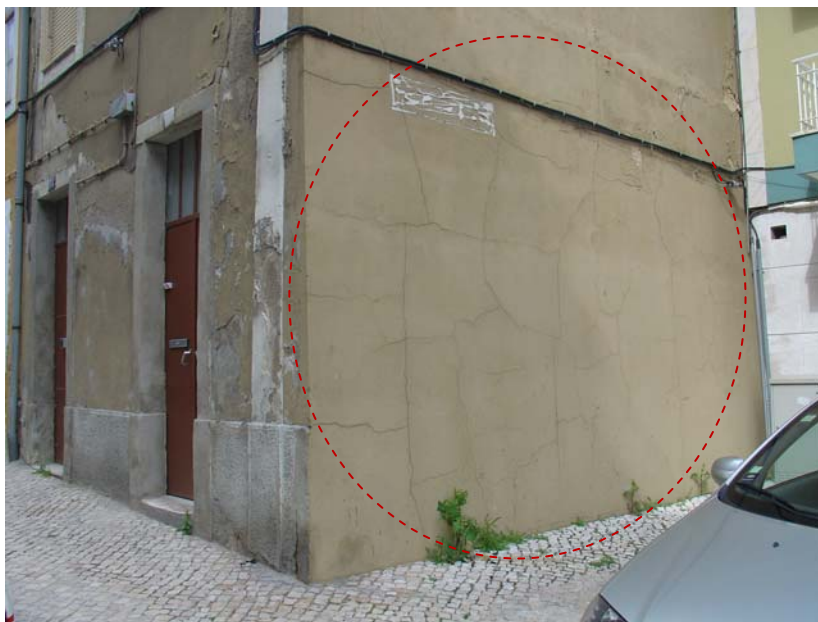
Figura 53 – Fendilhação de rebocos devido à retracção restringida do reboco (F-D5)
