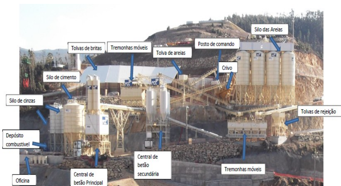
Figura 43 – Instalações da central de betão
