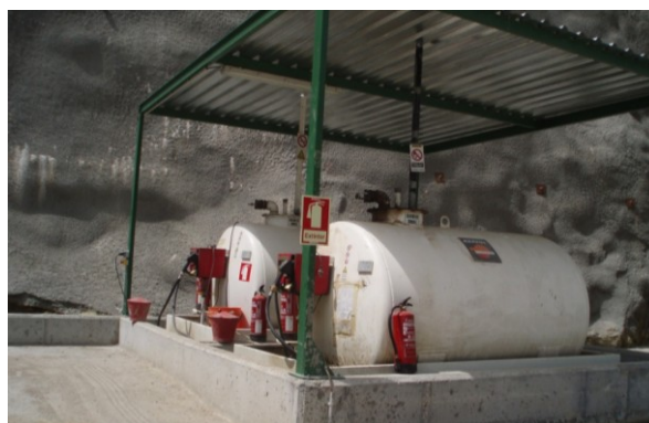
Figura 6 – Depósito de combustível
