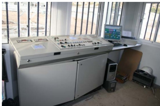
Figura 45 – Painel de comando da central de betão
