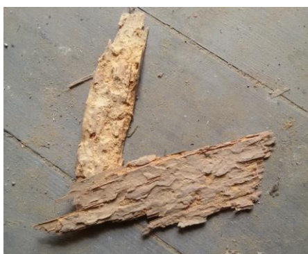
Figura 6.30- Parte de madeira destacada da viga
