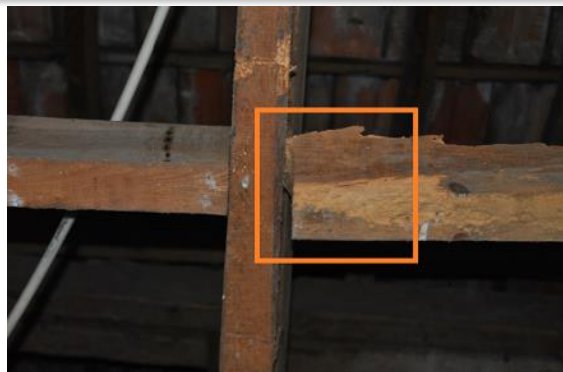
Figura 6.17- Degradação e alteração das condições do apoio
