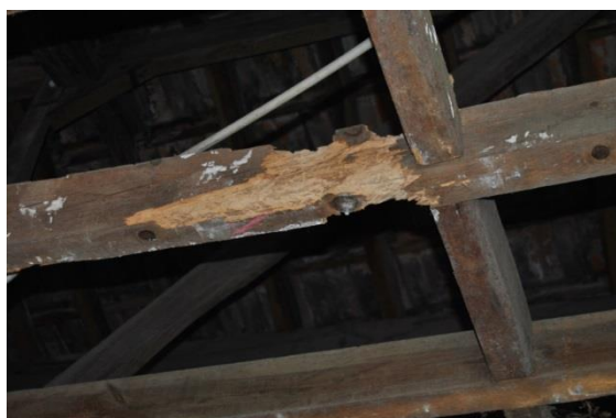
Figura 6.19-Degradação na viga 7 esquerda
