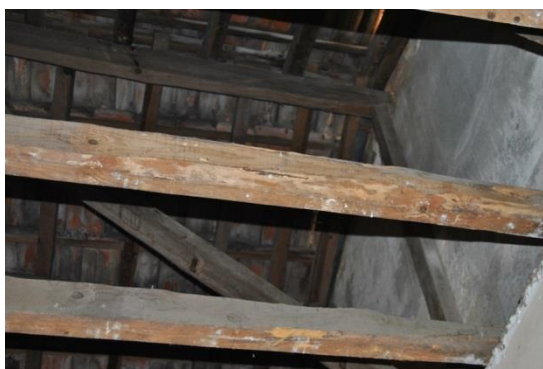
Figura 6.21- Alteração cromática na viga 7 direita
