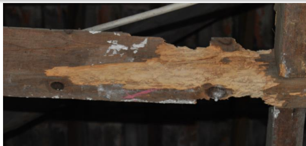
Figura 7.2- Nó em zona de degradação
