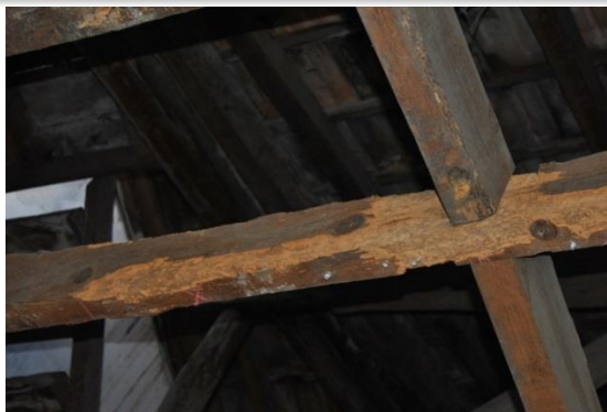
Figura 6.14- Degradação biológica na viga 4direita
