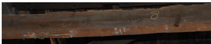
Figura 6.25- Degradação da viga 8direita
