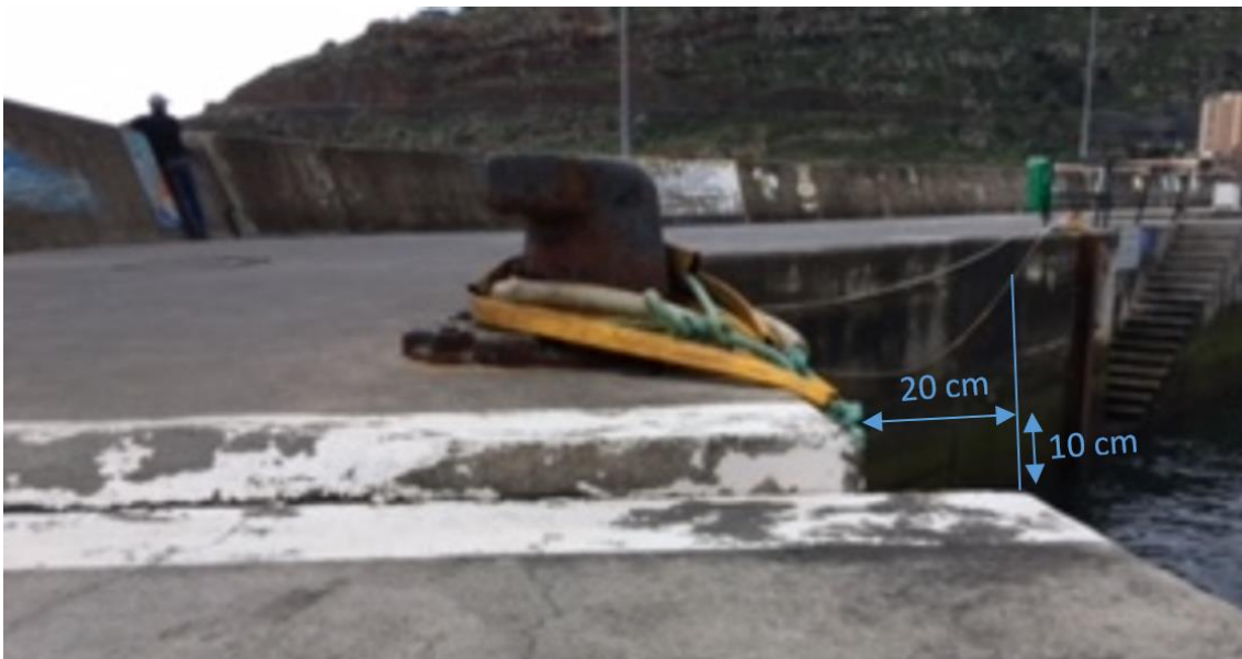
Figura 12: Evidências de cedência do caixotão – módulo nº6
