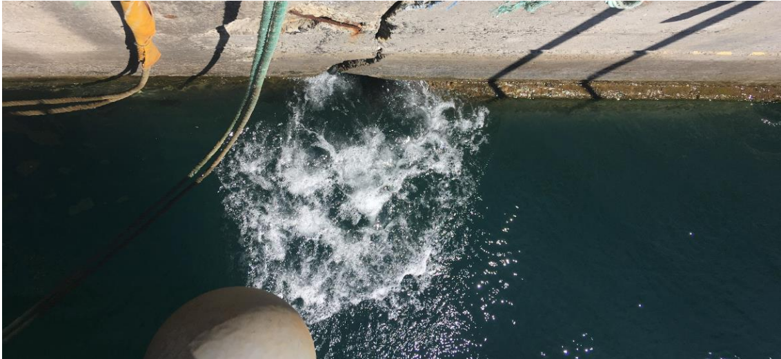
Figura 11: Junta com passagem de água importante
