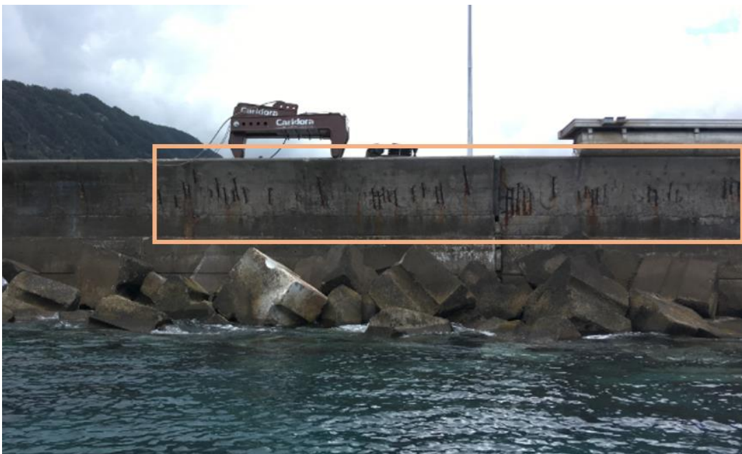
Figura 15: Armaduras corroídas ao longo do muro-cortina do cais
