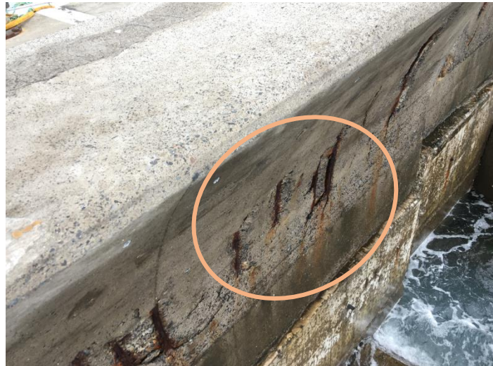
Figura 14: Evidências de corrosão das armaduras no muro-cortina
