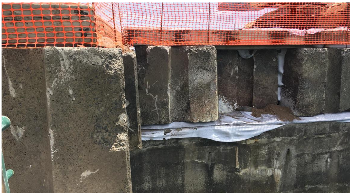
Figura 57: Medidas de prevenção de forma a manter a integridade do cais com manta geotêxtil
