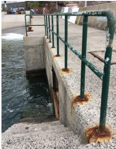
Figura 21: Corrosão evidente nas guardas
