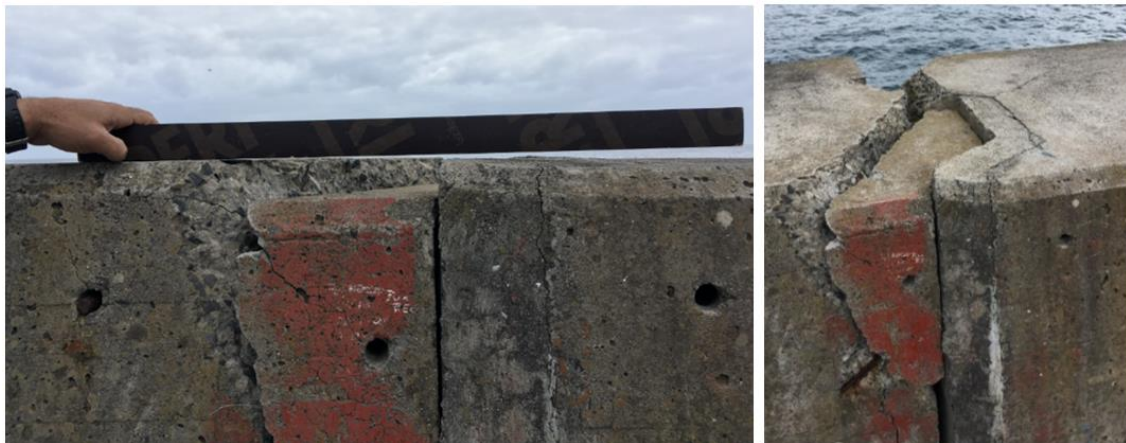
Figura 10: Juntas dos caixotões degradadas
