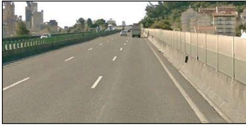
Figura 3.18 – Berma reduzida no Sublanço Alverca/ Vila Franca de Xira da A1 [21]
