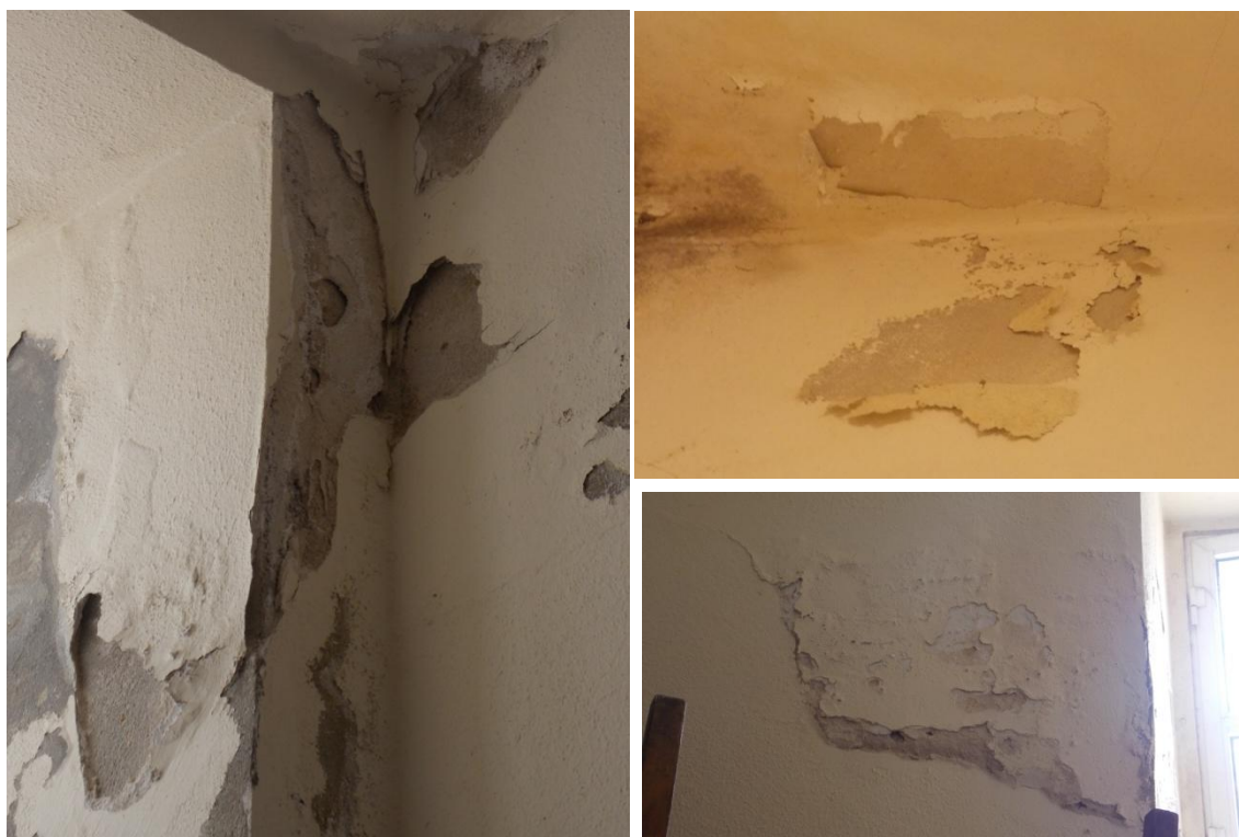
Figuras 18, 19 e 20 – Eflorescências e cripto-eflorescências (respectivamente, Arrecadação, Cozinha/Bar e Arrecadação)
