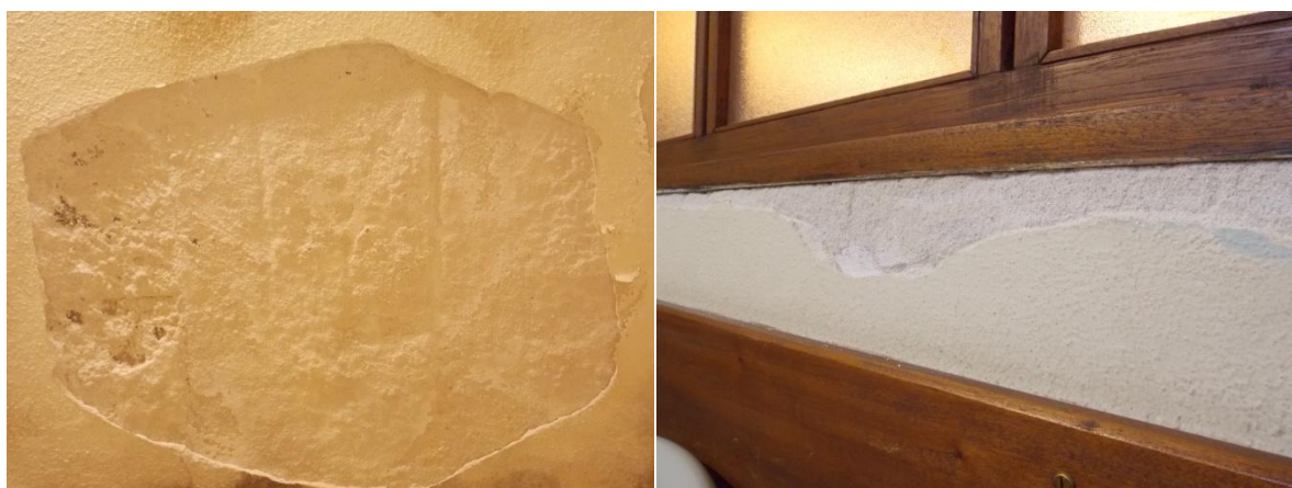
Figuras 21 e 22 – Esboroamento (respectivamente, Cozinha/Bar e Sala 9)
