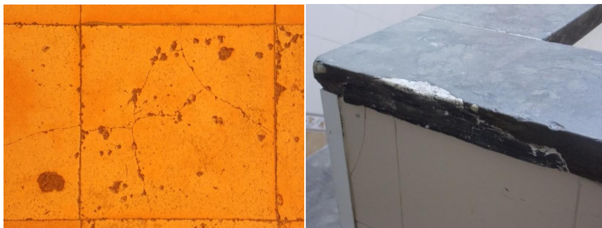
Figuras 25 e 26 – Degradação física dos materiais (respectivamente, pavimento cerâmico – Salão Paroquial – e corrimão - acesso Norte)
