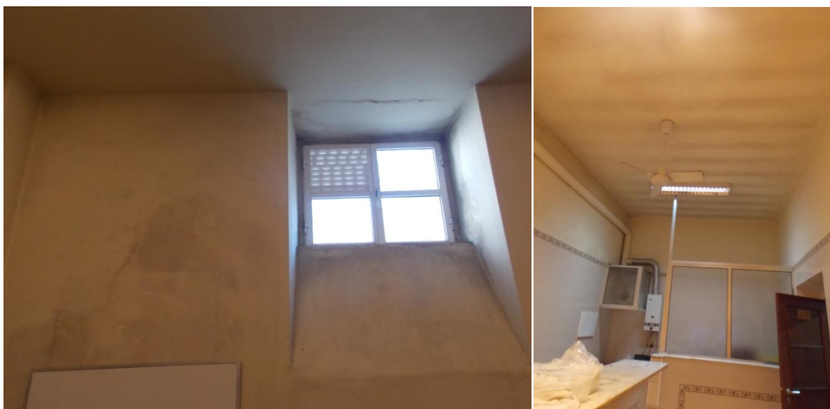
Figuras 14 e 15 – Manchas de humidades interiores (respectivamente, Sala 10 e Bar)
