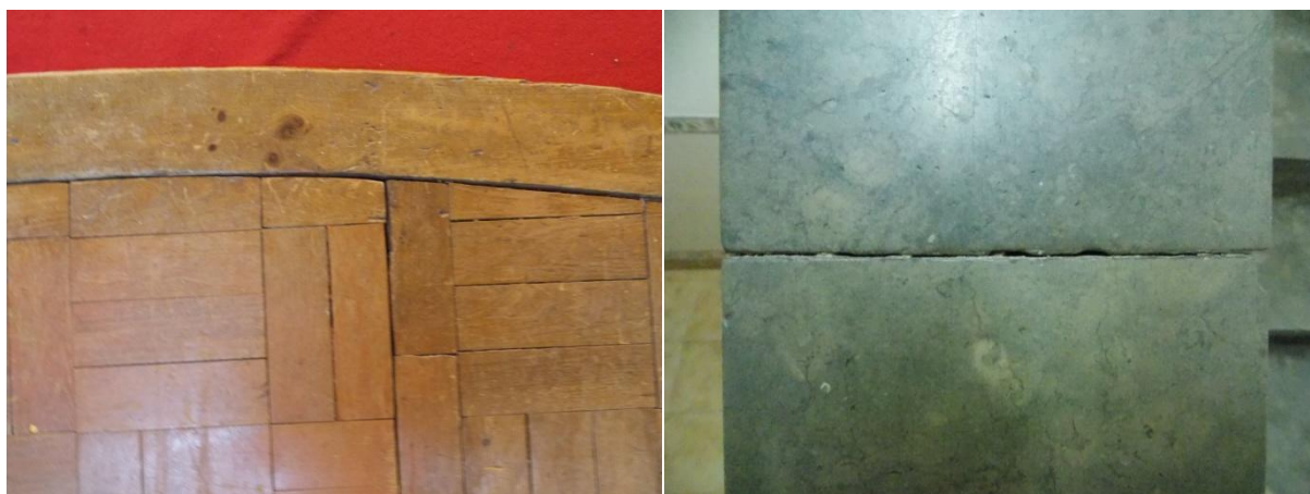
Figuras 23 e 24 – Desaparecimento do material da junta (respectivamente, pavimento do palco e corrimão – acesso Norte)
