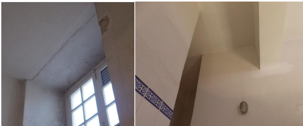
Figuras 12 e 13 – Fissuração (Instalações Sanitárias)
