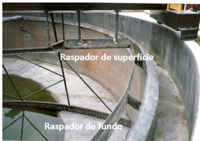
Figura 8. Decantador circular – ETAR de S. João Talha
