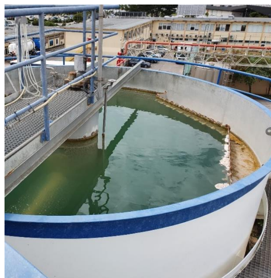
Figura 21. Tanque de descarga do decantador secundário – ARI clarificada
