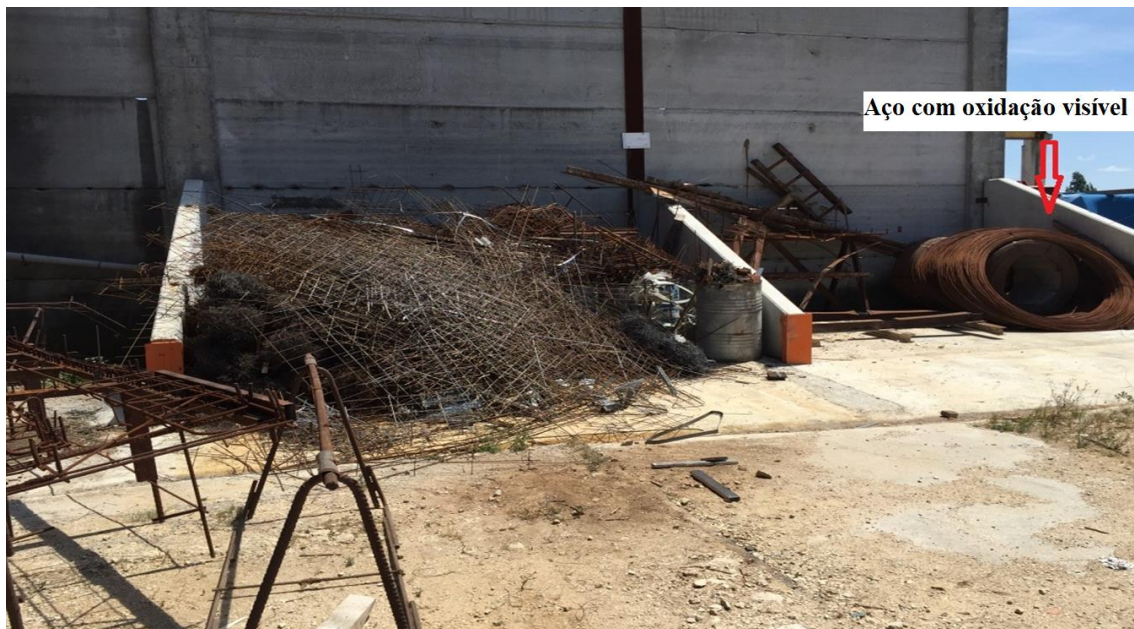
Figura 4.23 - Zona de armazenamento do aço exterior com aço oxidado
