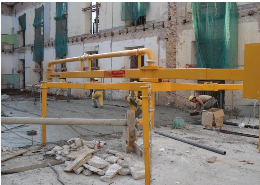
Figura 116 - Organização da obra sobre o betão após a sua secagem e endurecimento [B6]
