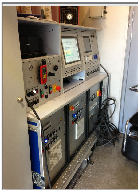
Figura 3.13 - Central de controlo de cura.
