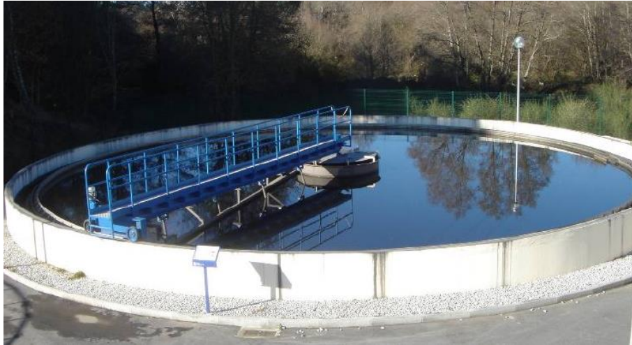
Figura 8 - Decantador secundário: ETAR de Seia (Cerdeira, 2008)
