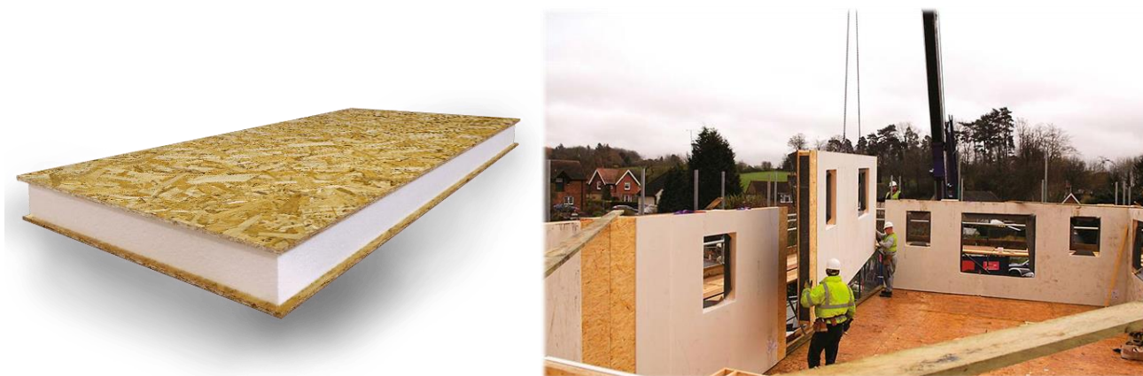
Figura 5.5 – Esquerda: painel isolado estrutural (SIP); direita: construção através do sistema por painéis SIP [50]
