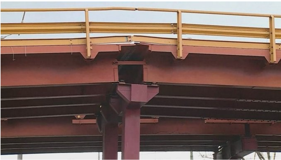
Figura 2.2 Ponte metálica numa situação de quase colapso devido a um incidente. A biela ligando as vigas aumentou significativamente a robustez da estrutura.
