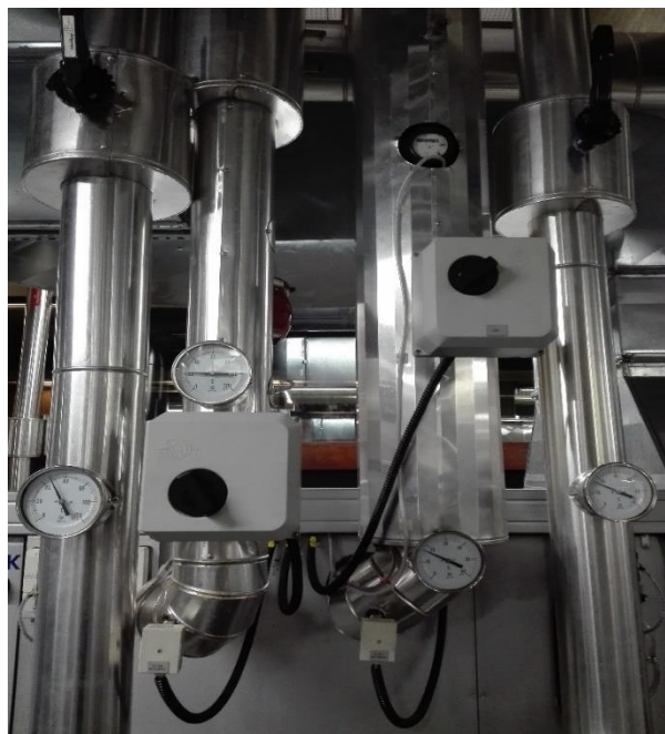
Figura 4.4 - Válvulas de regulação da água fria/quente.
