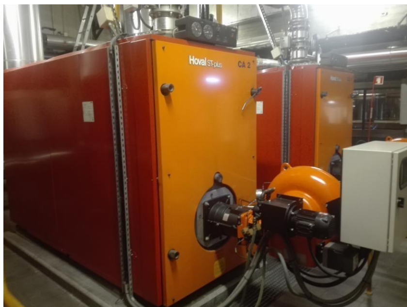
Figura 3.5 - Caldeiras da instalação.
