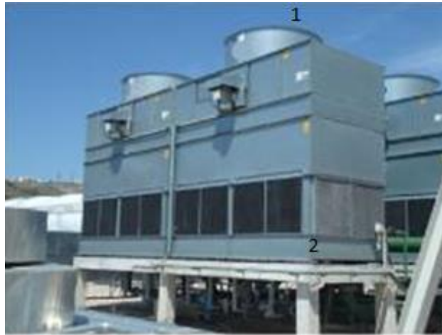
Figura 2.19- Torre de arrefecimento [43].
