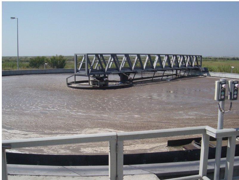
Figura 8: Decantador secundário. Fonte: ETAR de Alverca, 23 de Maio de 2013.
