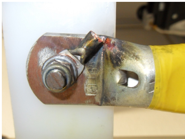
Figura 112 – Quebra do condutor de cobre aos terminais de um atuador devido à má cravagem dos mesmos.
