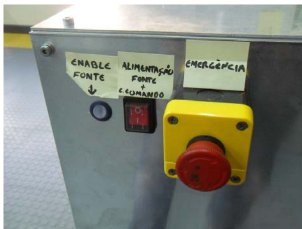
Figura 110 – Aparelhagem de comando local. Da esquerda para a direita, o interruptor de habilitação/inibição da fonte de alta tensão, o interruptor de corte da alimentação e o interruptor de corte de emergência.
