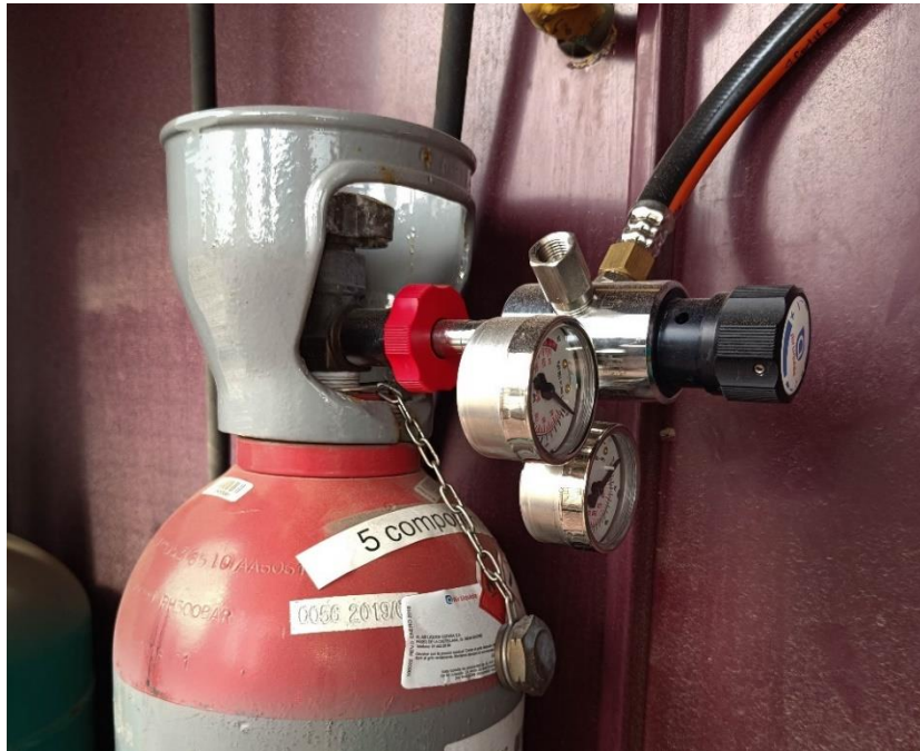
Figura 3.7 - Instalação do redutor de pressão.
