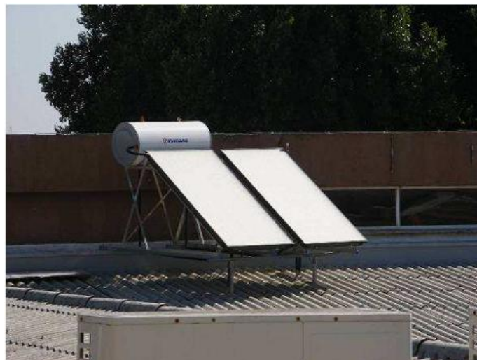
Figura 2.2 - Colectores solares instalados na cobertura do edifício [6]
