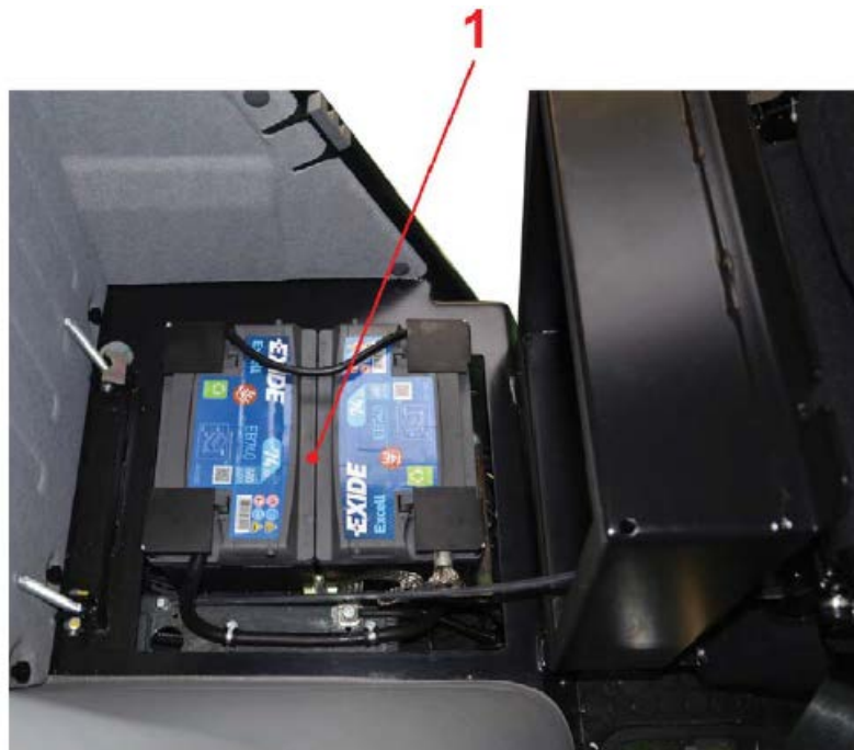
Figura 12: Baterias da Varredoura (Ravo, 2015)
