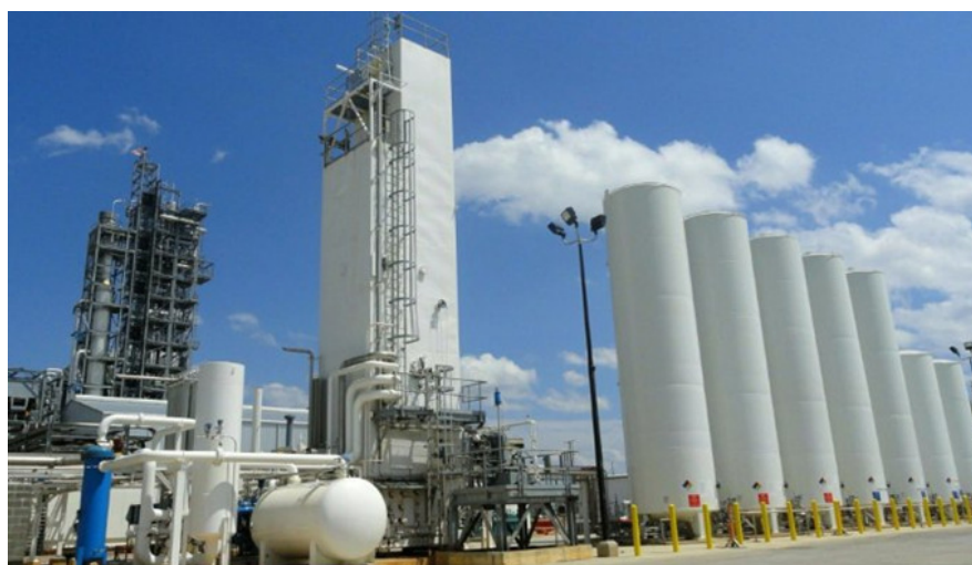
Figura 10 - Unidade de Separação de Ar (ASU)
