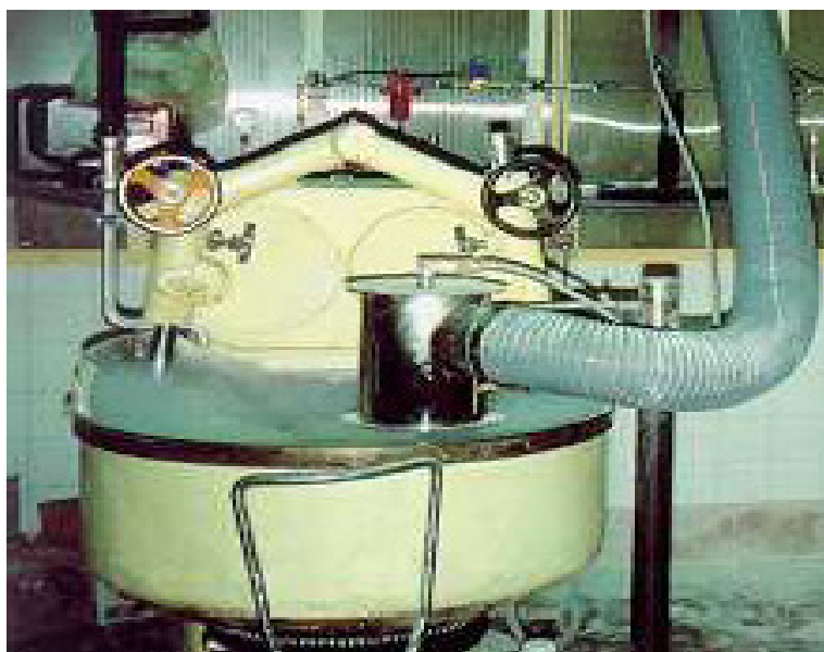
Figura 19 - Arrefecimento de massas em amassadora com injeção de CO 2 líquido
