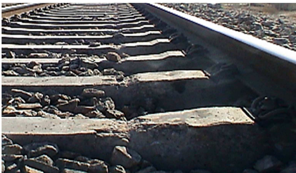
Figura 18 - Fendilhação de travessas de betão [24]
