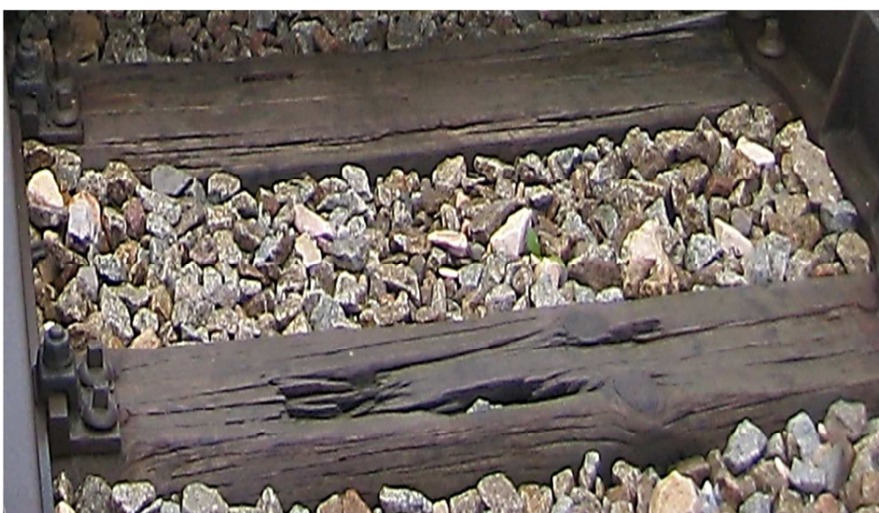
Figura 19 - Fendilhação de travessas de madeira [8]
