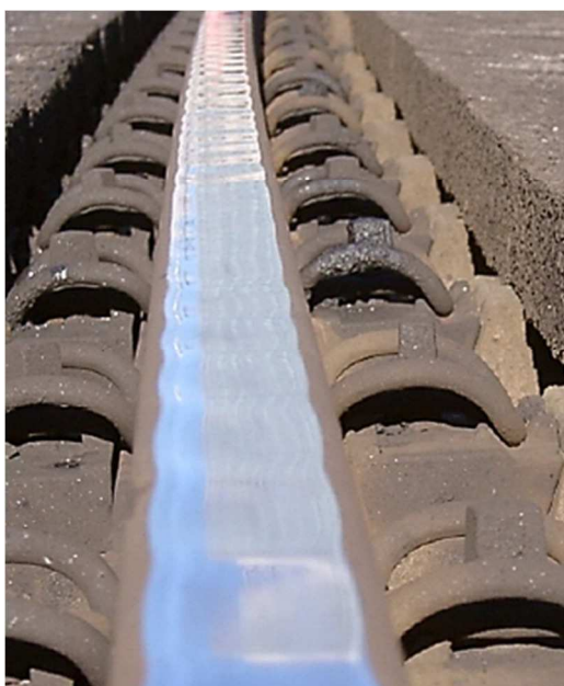
Figura 17 - Desgaste ondulatório do carril [1]
