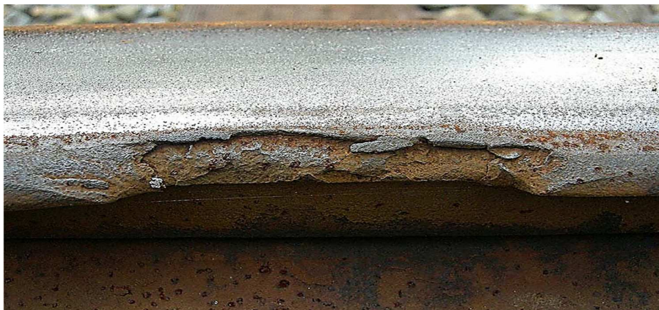
Figura 16 - Deterioração do carril [H]
