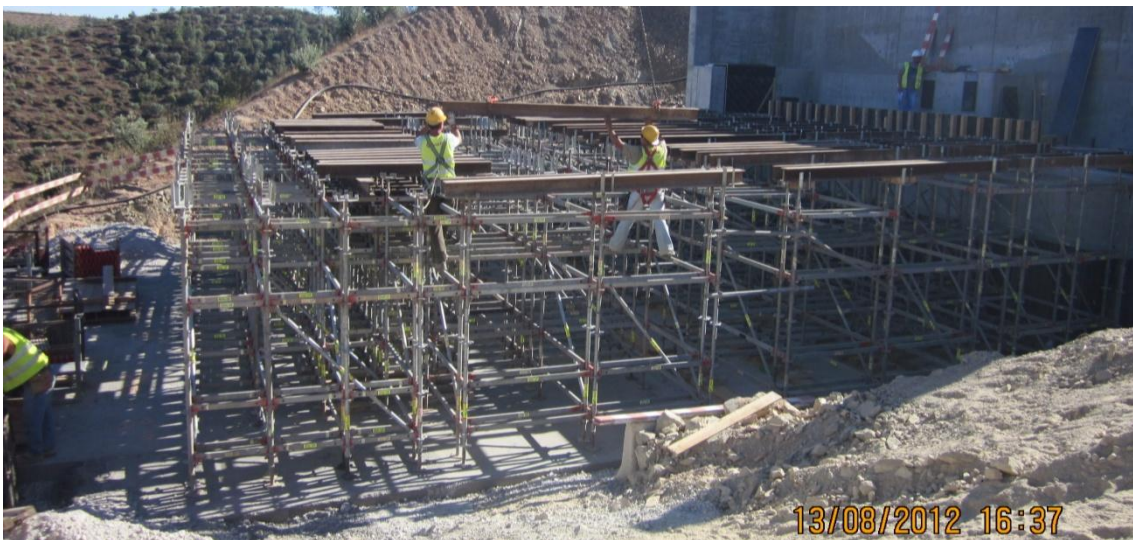
Plataformas desniveladas, cimbre ao solo e salva taludes (junto dos encontros)
