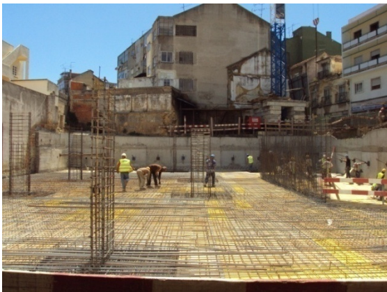
Figura 6.9. – Execução dos pilares e muros de apoio das rampas nos pisos -3, -2 e -1
