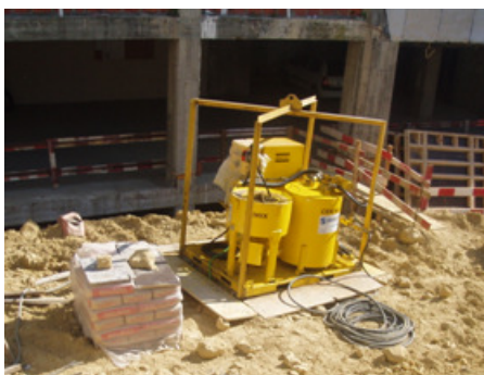
Figura 3.10. – Central de injeção e selagem
