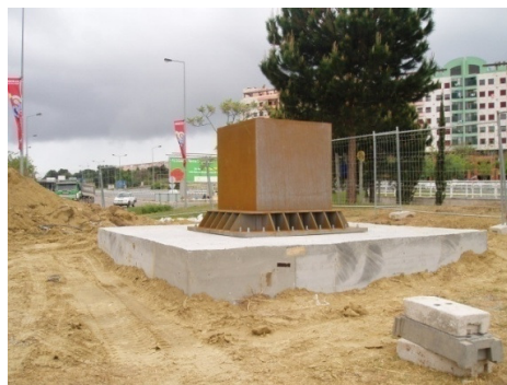
Foto – Diferentes fases durante a empreitada da execução das fundações para a escultura da “Coluna do tempo”
