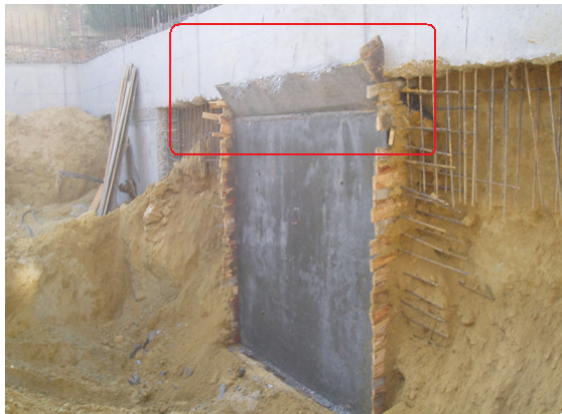
Figura 3.28. – “Bico de pato” no painel, após descofragem
