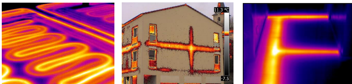
Figura 4.28 – Exemplos de defeitos encontrados em edifícios pela Termografia.
