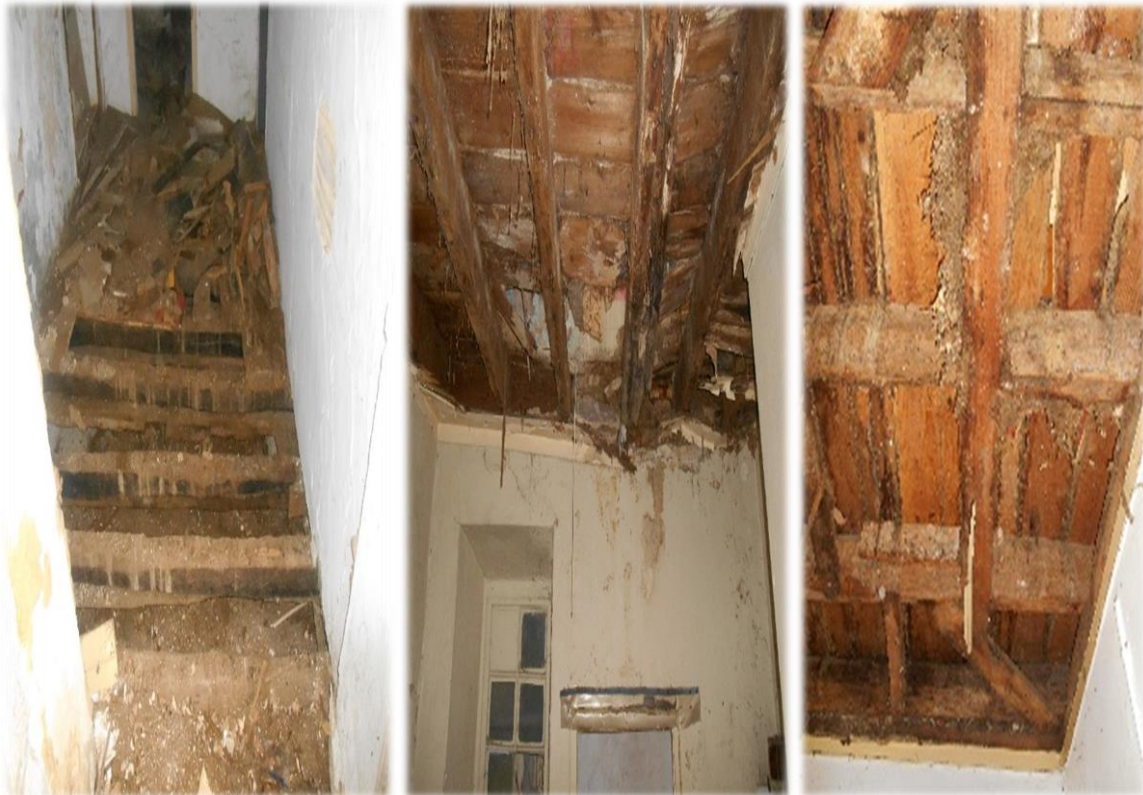
Fig. 40 - Empolamento do pavimento e apodrecimento dos elementos de madeira
