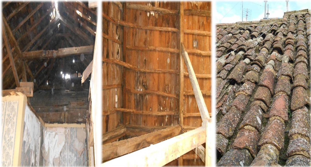
Fig. 42 – Estrutura da cobertura degradada
