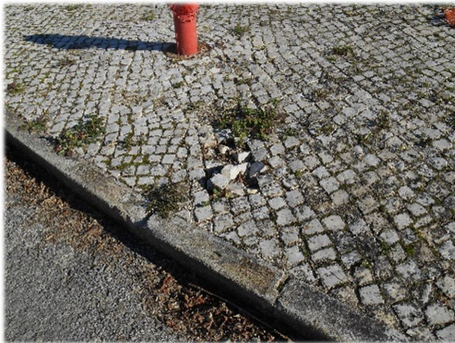
Fig. 24 - Calçada de vidro miúda solta e empolada
