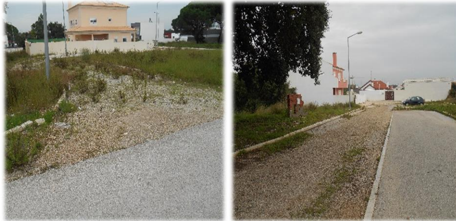
Fig. 12 – Camada de desgaste inexistente
