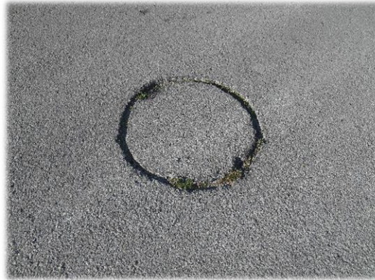
Fig. 27 – Tampa de caixa de visita mal não acessível
