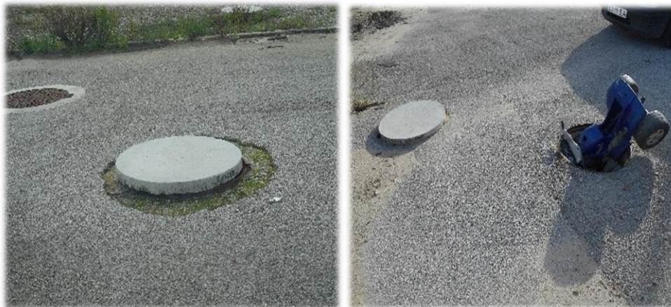
Fig. 19 - Ausência de tampas em ferro fundido em câmaras de visita
