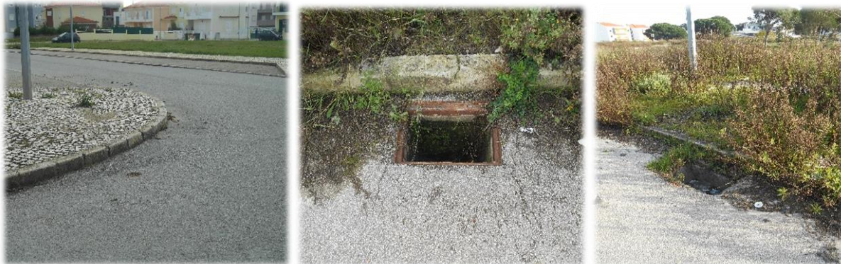
Fig. 16 – Anomalias na rede de drenagem pluvial
