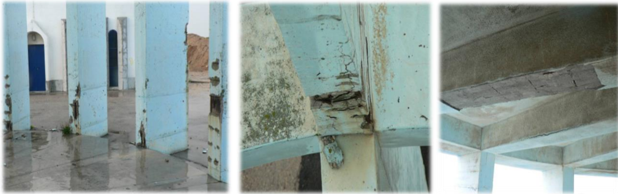
Fig. 4 - Delaminação do betão e corrosão das armaduras
