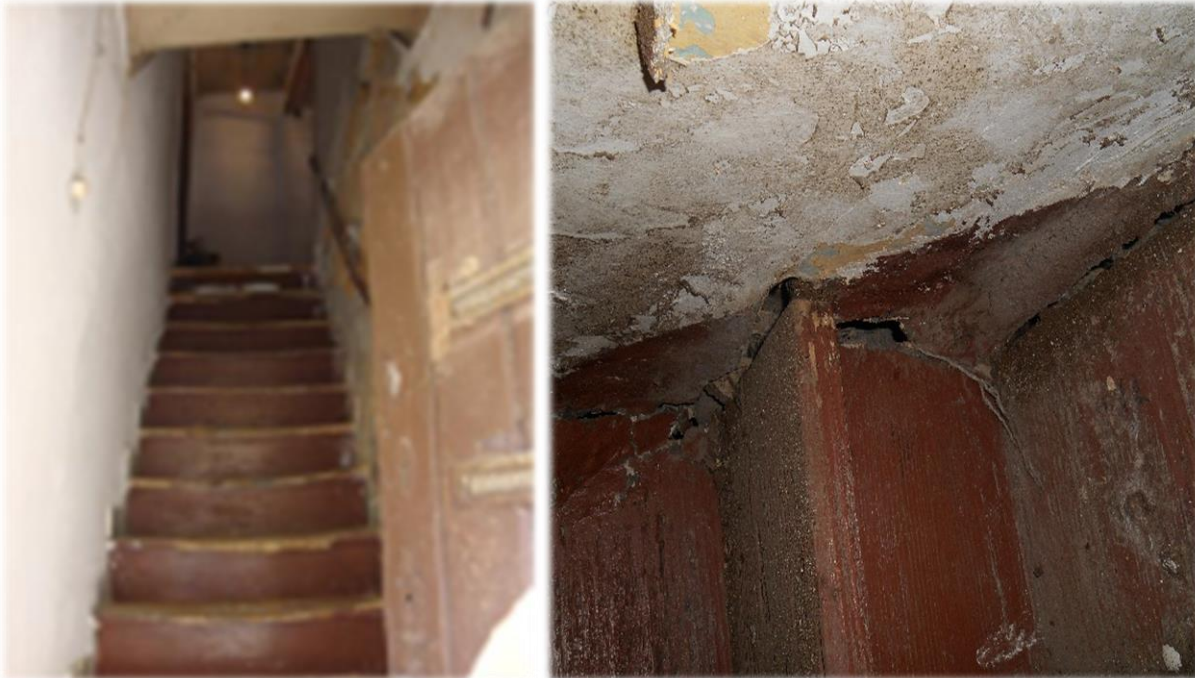
Fig. 43 – Escadas desligadas das paredes estruturais e deformadas à flexão
