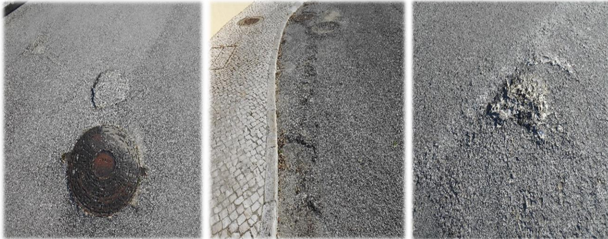
Fig. 23 – Anomalias na camada de desgaste
