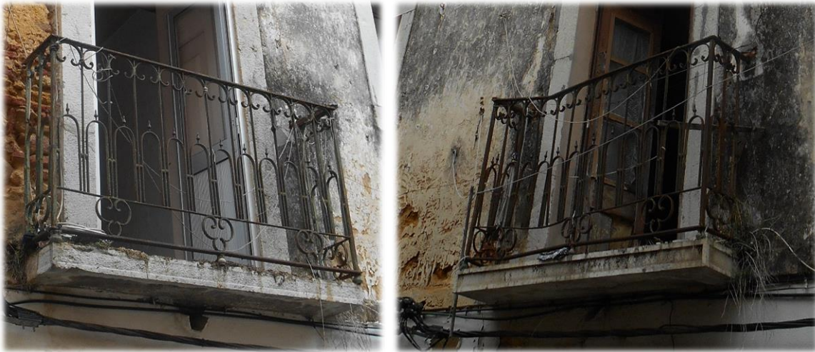
Fig. 44 – Guardas de ferro nas varandas e janelas em avançado estado de corrosão
