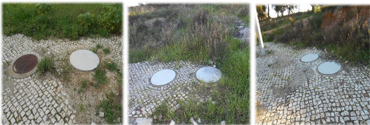
Fig. 17 - Ausência de tampas em ferro fundido
