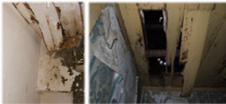
Fig. 45 - Revestimentos em madeira dos tetos do último piso em degradação total
