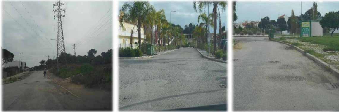
Fig. 15 – Passadeiras para peões inexistentes e sinalização vertical inexistente
