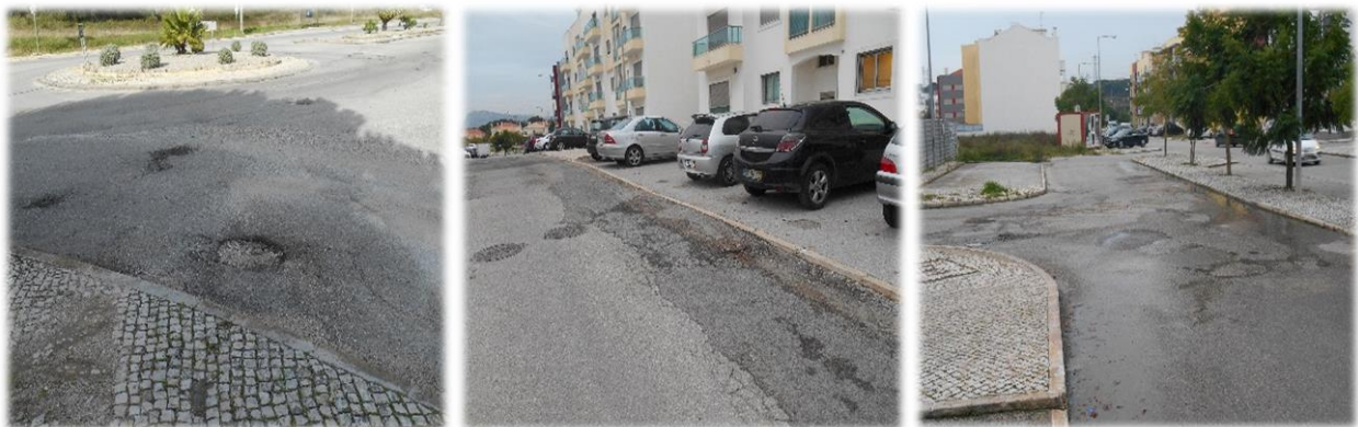
Fig. 11 – Anomalias no pavimento betuminoso
