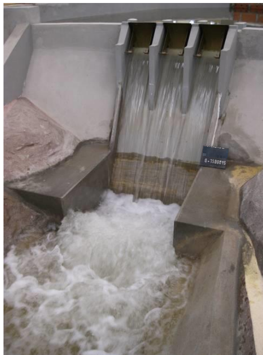
Foto 31 – Solução B. Escoamento do caudal 1500 m 3 /s
