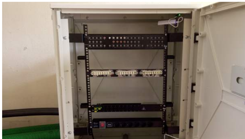
FIGURA 4.4: Nó na parte de cima do armário.
