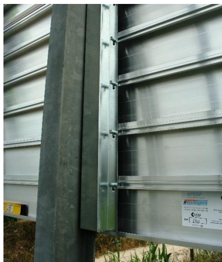
Figura 4.28 – Dispositivos de proteção anti-roubo de painel de sinalização
