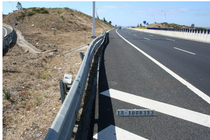
Figura 3.2 – Registo fotográfico de dano em guarda de segurança na A8
