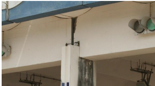
Figura 3.7 – Controlo de deslocamentos nos edifícios com crackmeter
