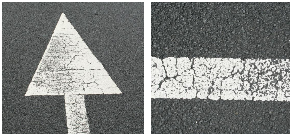
Figura 4.10 – Sinalização horizontal desgastada
