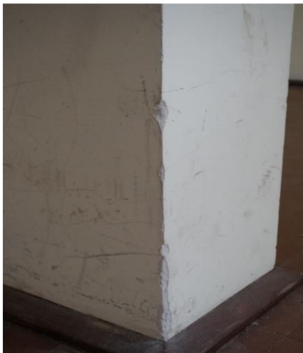
Figura 6 – Destacamento do reboco na parede
