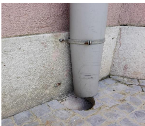
Figura 57 – Sinais de colisão no tubo de queda
