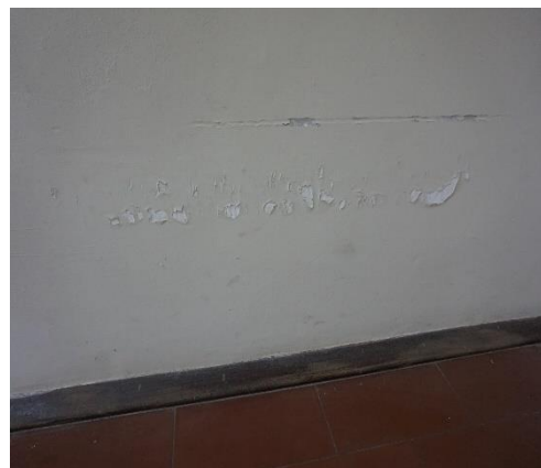
Figura 30 – Destacamento da pintura na parede
