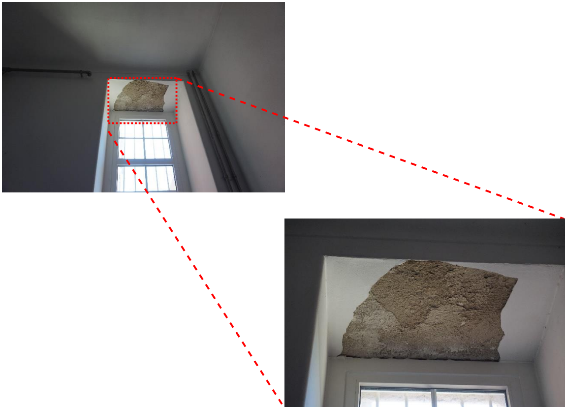
Figura 5 – Destacamento do Revestimento de estuque
