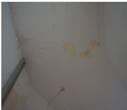
Figura 31 – Descasque da pintura no teto [Autor, 2016]
