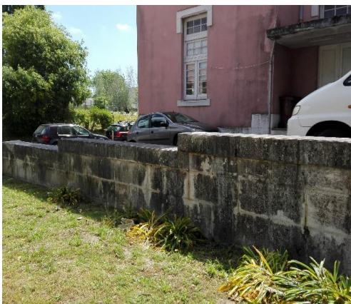
Figura 52 – Colonização Biológica, Manchas negras e Sujidade na Pedra de Calcário
