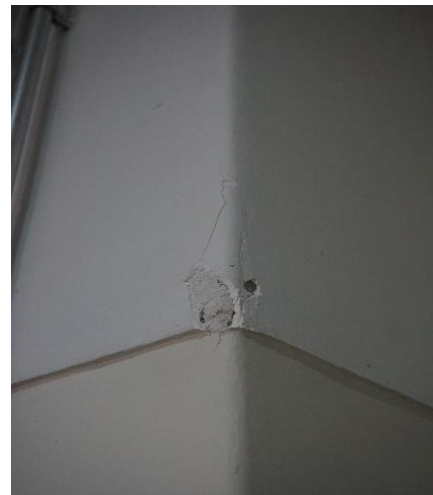
Figura 7 – Destacamento do reboco na parede
