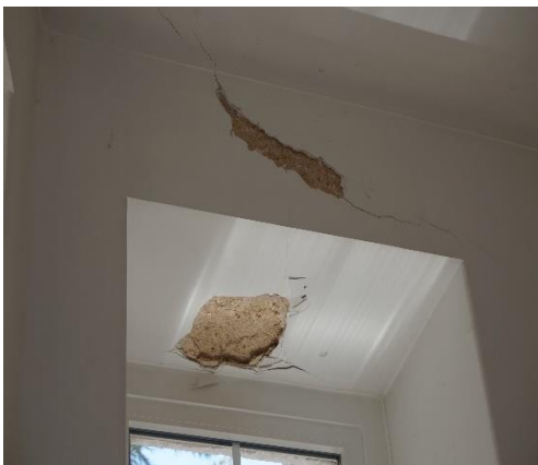
Figura 1 – Fissuração do revestimento de estuque
