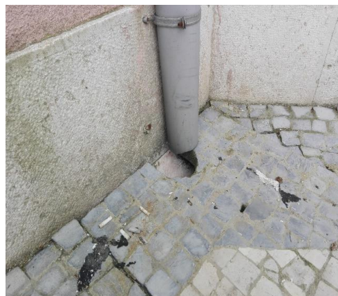
Figura 56 – Posicionamento deficiente do tubo de queda
