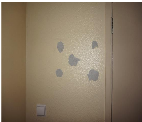
Figura 29 – Destacamento da pintura na parede
