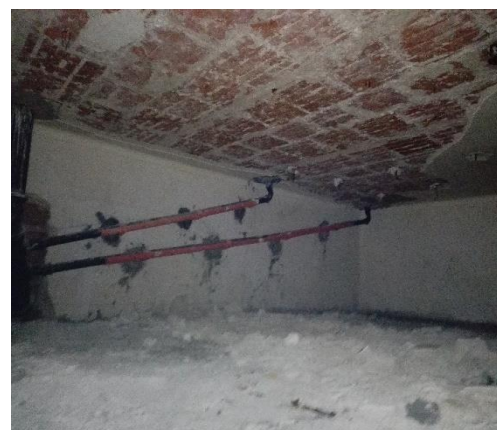
Figura 19 – Destacamento do revestimento da Laje aligeirada
