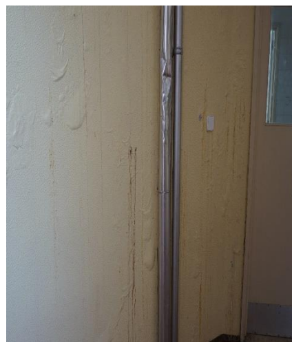
Figura 38 – Deformações nas redes de abastecimento de água quente
