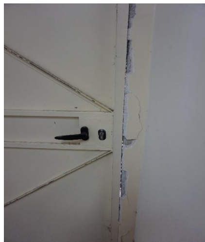
Figura 9 – Destacamento do reboco na periferia da porta
