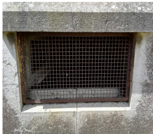
Figura 47 – Oxidação dos gradeamentos da cave
