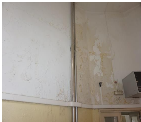
Figura 16 – Manchas de humidade na parede [Autor, 2016]
