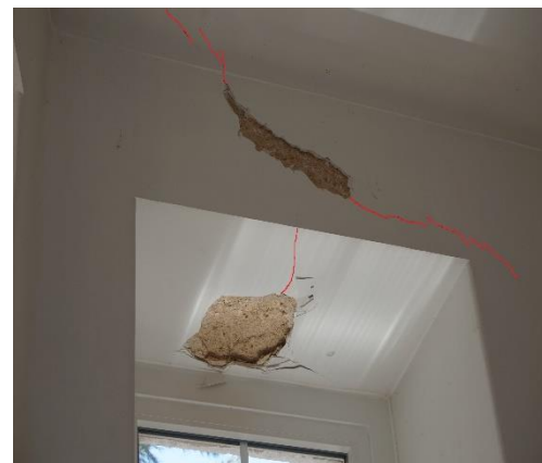
Figura 2 – Fissuração do revestimento de estuque
