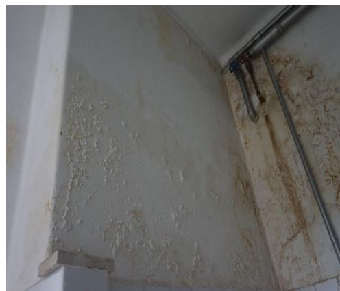
Figura 14 – Eflorescências e Criptoflorescências na parede
