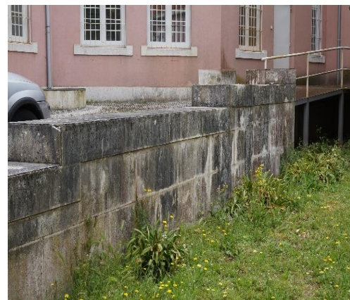
Figura 53 – Colonização Biológica, Manchas negras e Sujidade na Pedra de Calcário
