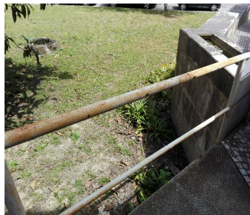
Figura 49 – Oxidação do corrimão de entrada
