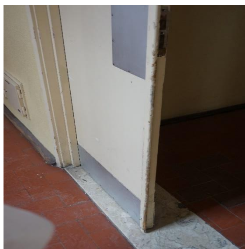
Figura 42 – Deterioração da porta de madeira
