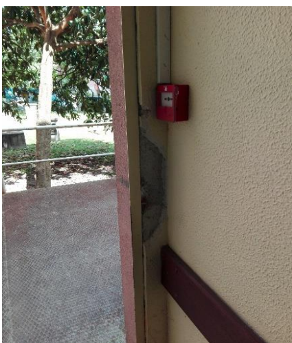
Figura 8 – Destacamento do reboco na periferia da porta
