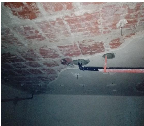
Figura 18 – Destacamento do revestimento da Laje aligeirada
