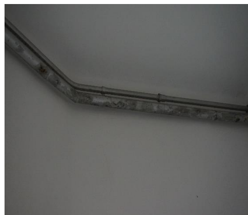
Figura 36 – Oxidação das redes de abastecimento de água
