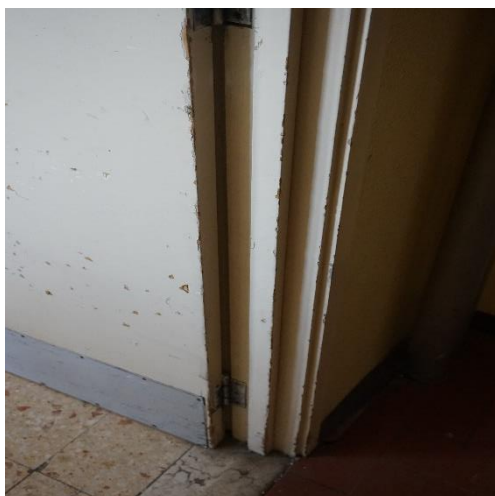
Figura 43 – Deterioração da porta de madeira
