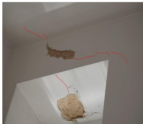
Figura 4 – Fissuração do revestimento de estuque
