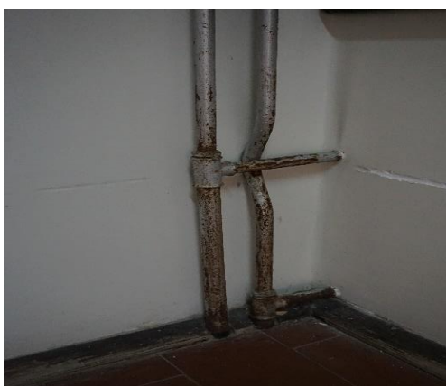
Figura 34 – Oxidação das redes de abastecimento de água
