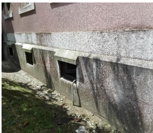
Figura 50 – Colonização Biológica, Manchas negras e Sujidade na Pedra de Lioz
