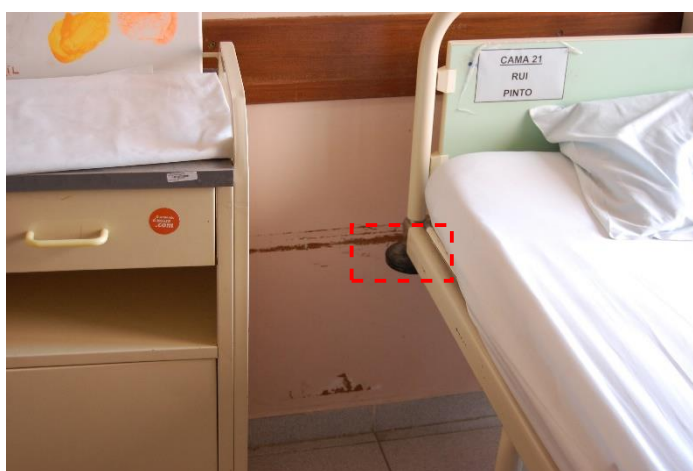
Figura 11 – Desgaste do reboco da parede com o batente das camas [Quessou & Cortesão, 2016]
