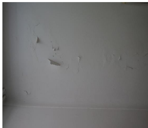
Figura 32 – Descasque da pintura no teto [Autor, 2016]
