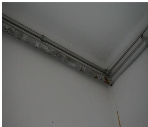
Figura 35 – Oxidação das redes de abastecimento de água
