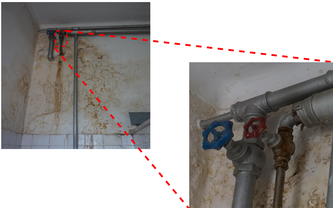
Figura 39 – Fuga de água e oxidação da canalização
