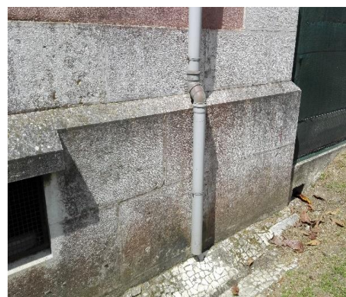
Figura 51 – Colonização Biológica, Manchas negras e Sujidade na Pedra de Lioz
