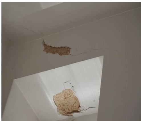
Figura 3 – Fissuração do revestimento de estuque
