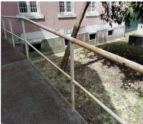
Figura 48 – Oxidação do corrimão de entrada
