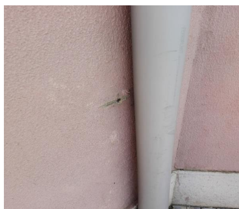
Figura 60 – Sinais de colisão no tubo de queda
