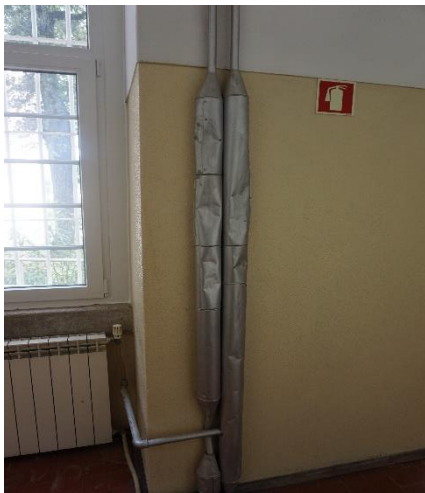
Figura 37 – Deformações nas redes de abastecimento de água quente
