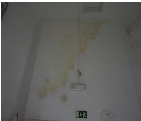
Figura 13 – Manchas de humidade na parede
