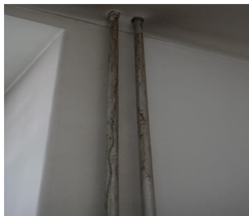
Figura 33 – Oxidação das redes de abastecimento de água
