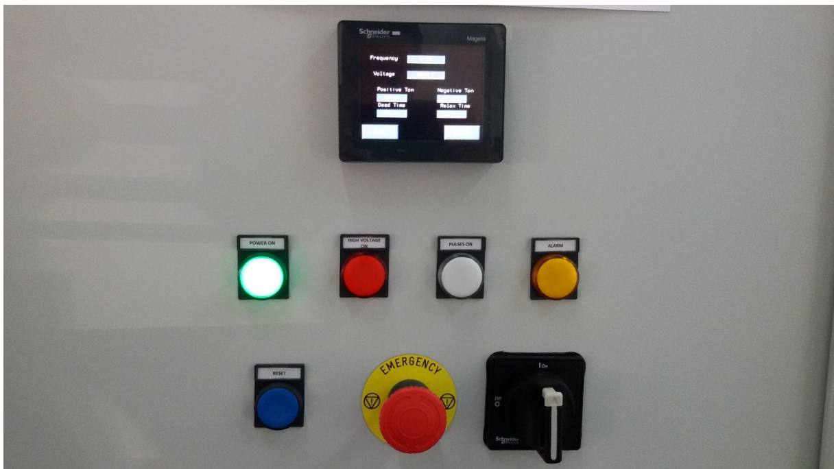
Figura 41 - Painel na porta do rack
