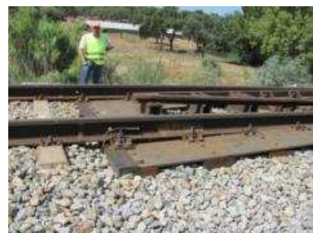
Figura 3-43 Detalhe aparelho carrilador ponte [13]
