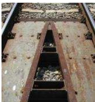
Figura 3-42 Detalhe aparelho carrilador ponte [13]
