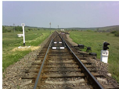
Figura 3-11 Travessas de madeira [13]
