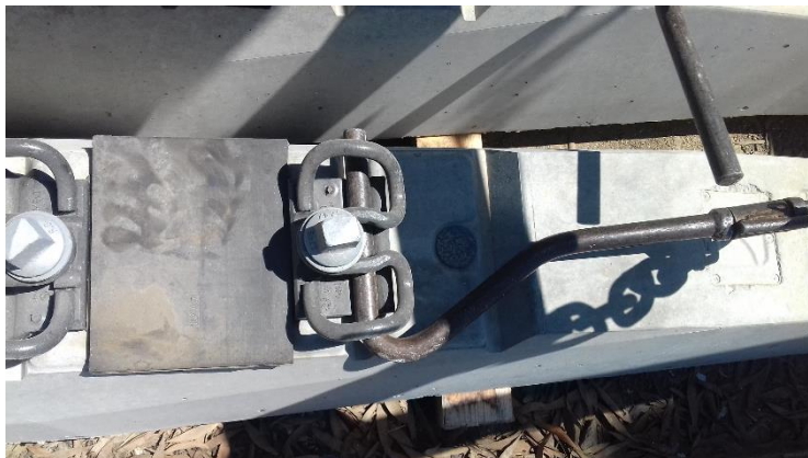
Figura 4.14 - Enganchamento na fixação elástica Vossloh.
