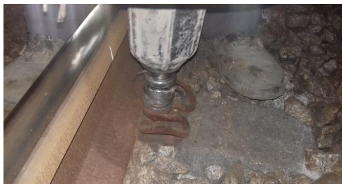
Figura 4.18 - Desaperto de fixações existentes.
