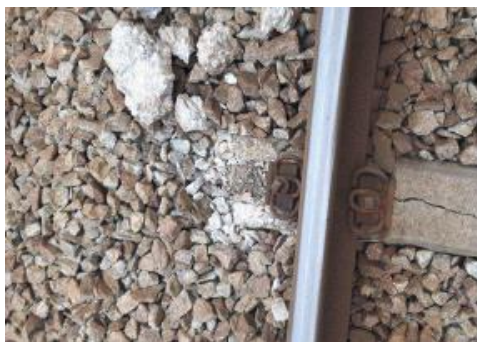
Figura 4.2 - Travessa degradada no Km 266.500. [36]
