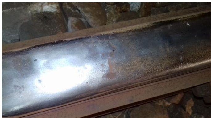
Figura 3.50 - Carril fissurado superficialmente.
