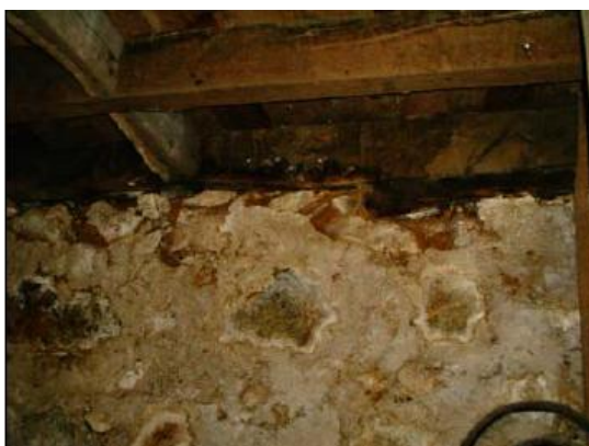
Figura 2.10 – Apoio do pavimento de madeira na parede em alvenaria de pedra [Lamego, 2005]
