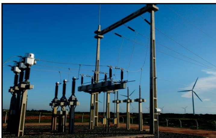
Figura 3.14 - Exemplo de subestação [s34].
