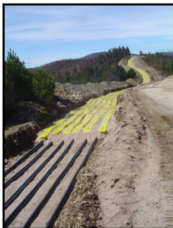
Figura 5.3 - Caminho de cabos [2].
