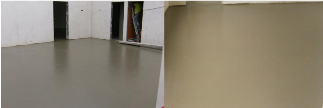
Fig 94 e 95 – Betonilha afagada.
