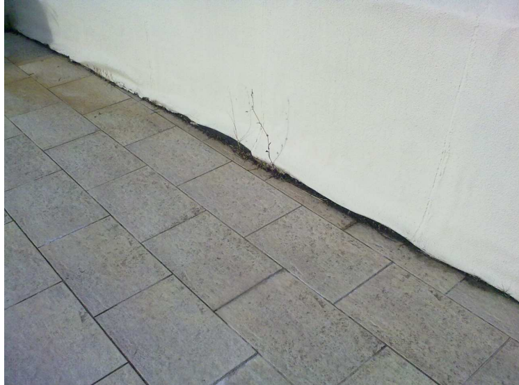
Figura 4.10 - Exemplo da ocorrência de deslizamento do sistema impermeabilizante num paramento vertical.
