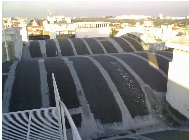
Figura 5.1.1 - Exemplo de um sistema impermeabilizante que atingiu o seu tempo de vida útil.
