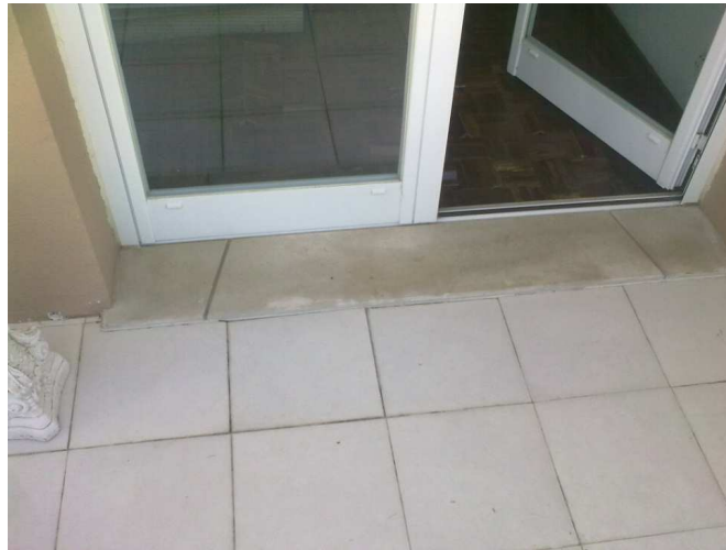
Figura 4.1 - Exemplo de erro de projeto - altura insuficiente para a execução do correto remate da soleira.
