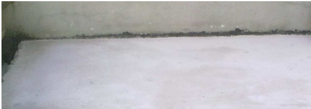
Figura 4.11 - Exemplo onde o sistema impermeabilizante não foi rematado a pelo menos 15cm do pavimento.
