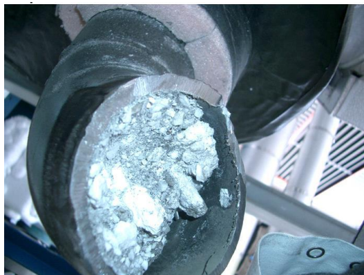
Figura 29 - Tubagem obstruída com carbamato de amônio [24]
