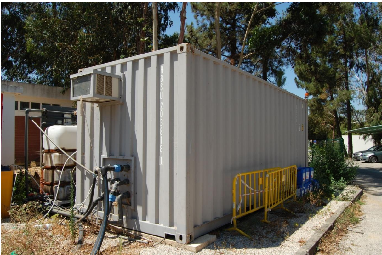
Figura 3.2 - Contentor onde se realiza o processo de osmose inversa.
