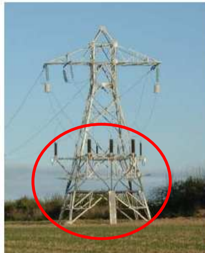
Fig.19 - Transições instaladas em plataformas nas torres, 110kV [1].
