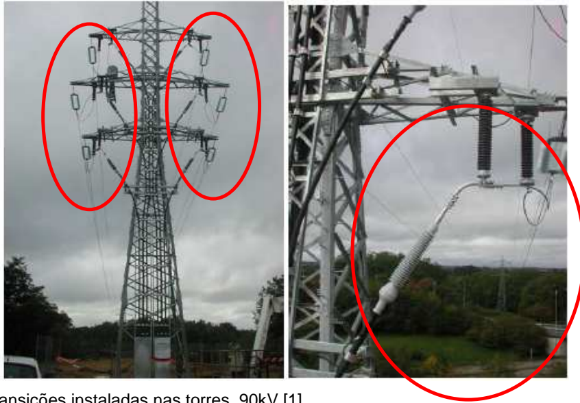
Fig.18 - Transições instaladas nas torres, 90kV [1].
