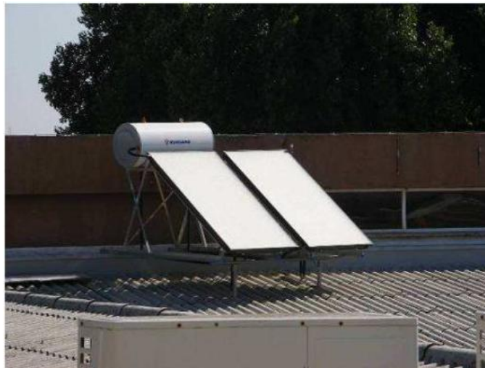
Figura 3. 14 Colectores solares térmicos instalados no telhado do refeitório (ISEL).
