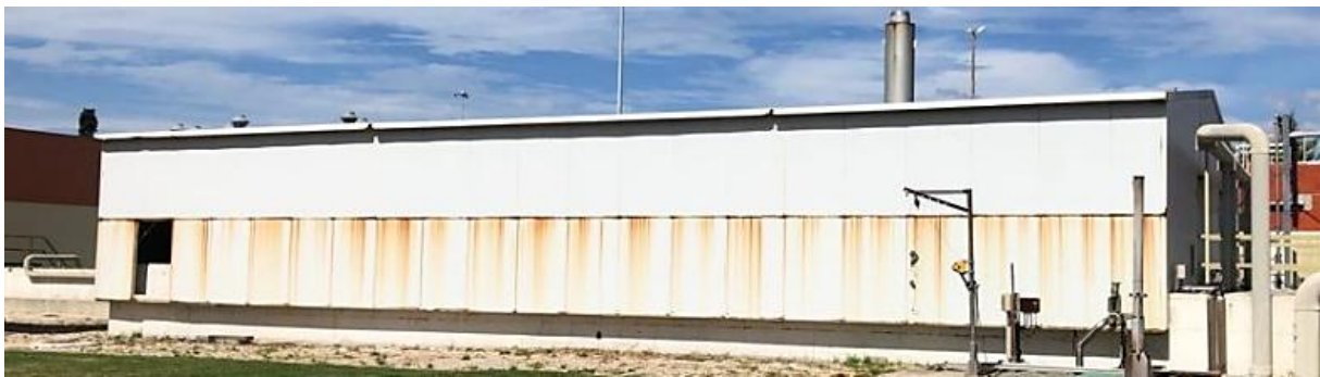
Figura 3.15 – Edifício do desarenamento/desengorduramento corroído.
