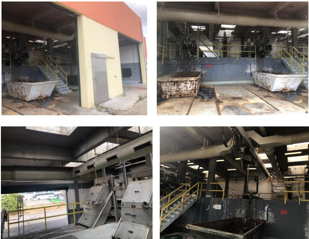
Figura 3.11 – Edifício de gradagem: portões abertos, escorrência de lixiviados, grelhas obstruídas e desvio com perda de carga acentuada.
