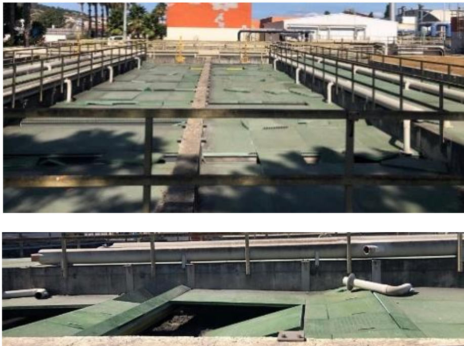
Figura 3.18 – Decantadores primários com coberturas levantadas e condutas partidas.
