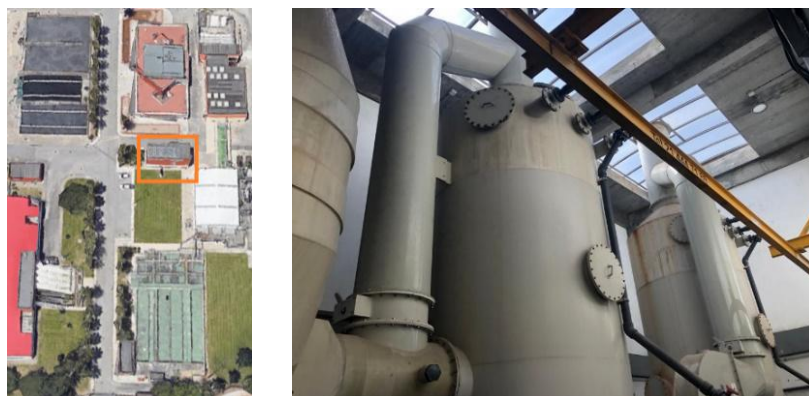
Figura 3.5 – Localização dos ventiladores e equipamentos de desodorização (à esquerda) e torres de lavagem química (à direita).
