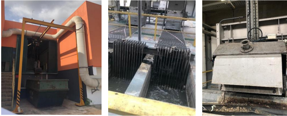
Figura 3.12 – Edifício de gradagem: contentor sem cobertura e porta partida, grades e tamisador.
