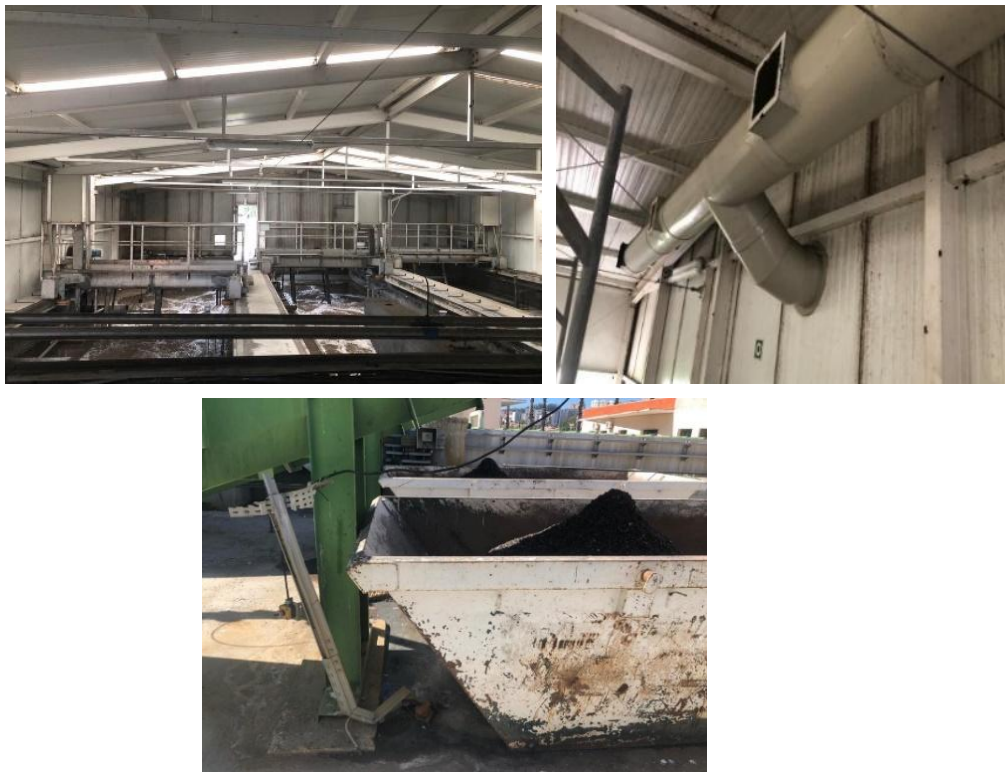
Figura 3.16 – Ventilação do edifício do desarenamento/desengorduramento: espaço com falta de pontos de extração, grelhas obstruídas sem regulação, contentorização sem cobertura.
